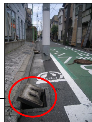
出火箇所周囲の状況
