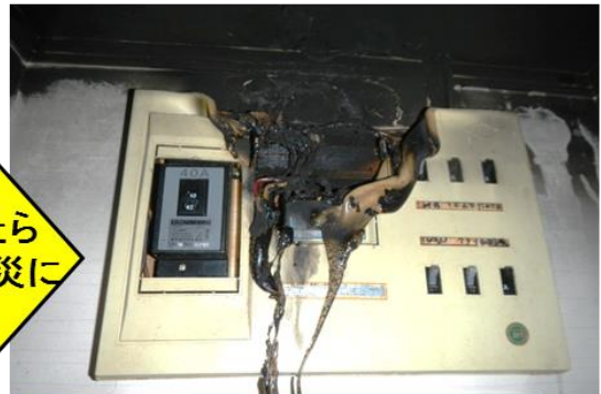
ブレーカーが燃えた火災
