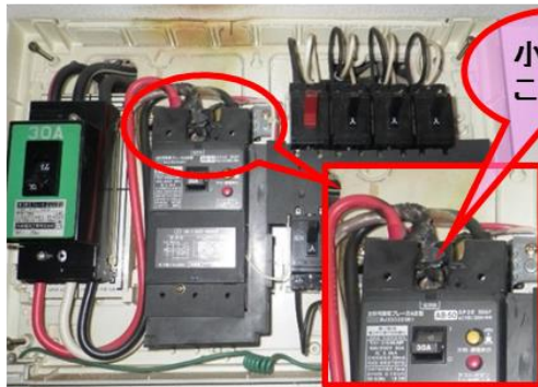
ブレーカーの小さなこげ跡
