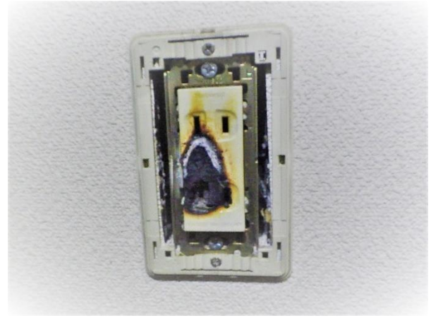
写真2 コンセントの焼損状況
