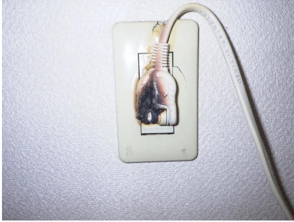
写真1 差込みプラグの焼損状況
