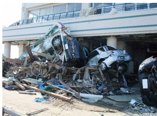
学校に流れ込んだ車両 写真提供：仙台市
