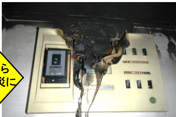
ブレーカーが燃えた火災
