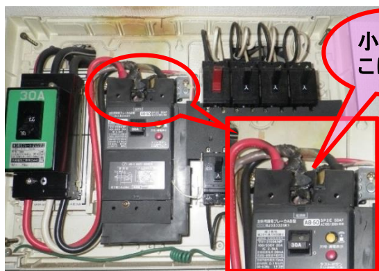
ブレーカーの小さなこげ跡
