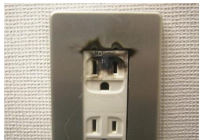
コンセントのこげ跡
