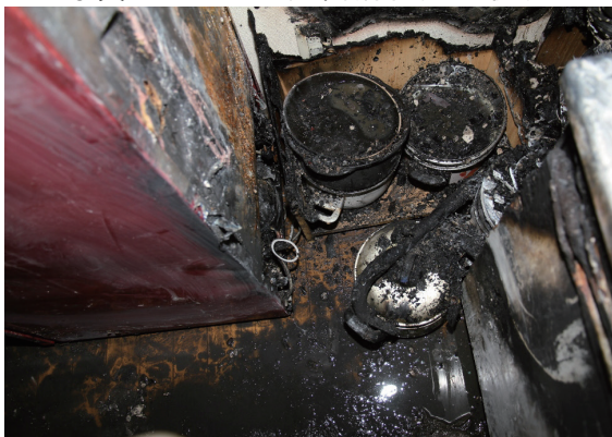
写真 2-6-3 出火箇所付近の状況
