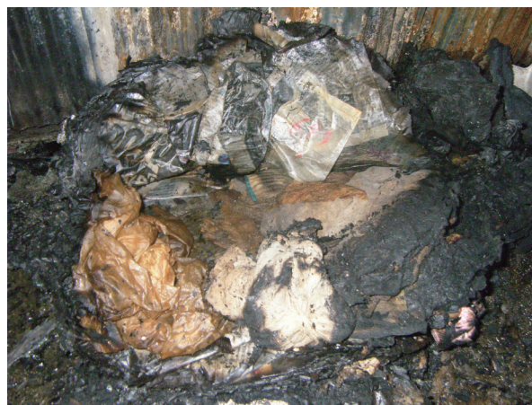
写真 6-8-2 出火箇所の焼損状況
