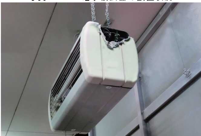
写真 3-5-4 電撃殺虫器の設置状況
