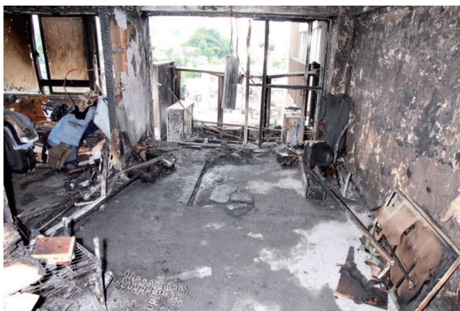
写真 8-2 出火室の焼損状況
