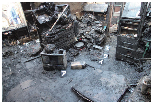
写真 5-1-2 出火室の状況
