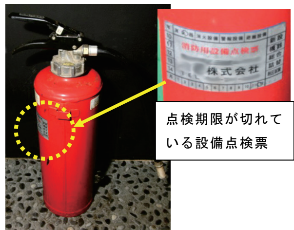
写真 7-4 使用できなかった消火器
