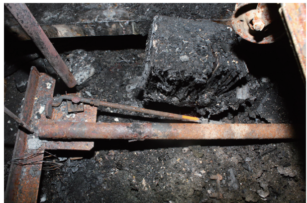
写真 6-8-4 出火したバッテリー付近の状況
