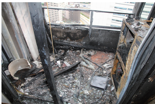
写真 2-2-1 出火したベランダの状況
