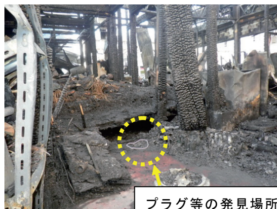
写真 6-1-6 出火箇所の焼損状況
