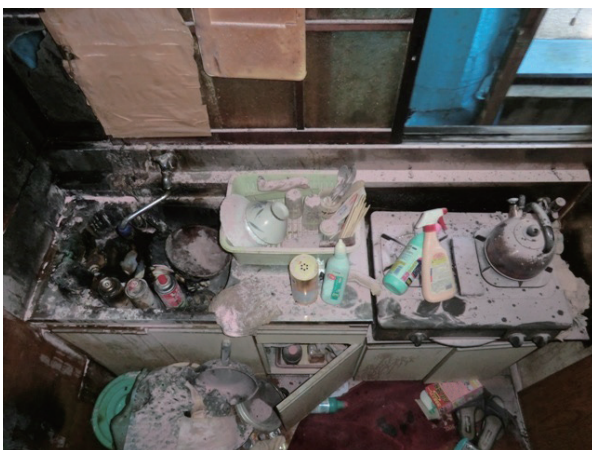
写真 3-4-3 爆発後の部屋の状況
