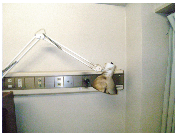
写真 6-5-2 アームライトの焼損状況
