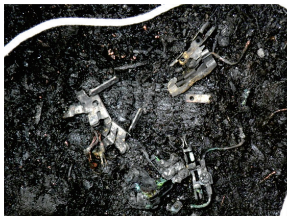
写真 6-1-7 溶融したプラグ等の状況
