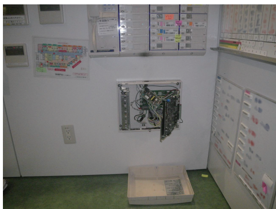
写真 2-6-1 制御盤内部の状況
