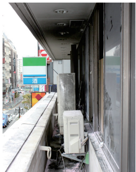
写真 8-4 ベランダの焼損状況
