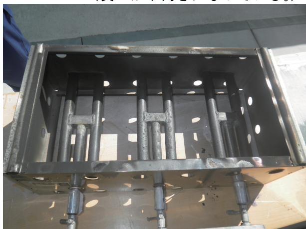
写真 2-7-1 ガス鉄板焼器の誤った設定状況 (炎口が下向きになっている。)
