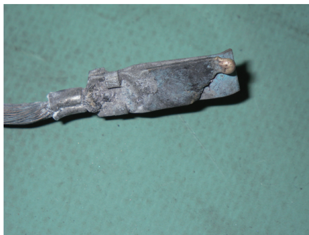
写真 6-3-2 延長コード受け刃の焼損状況
