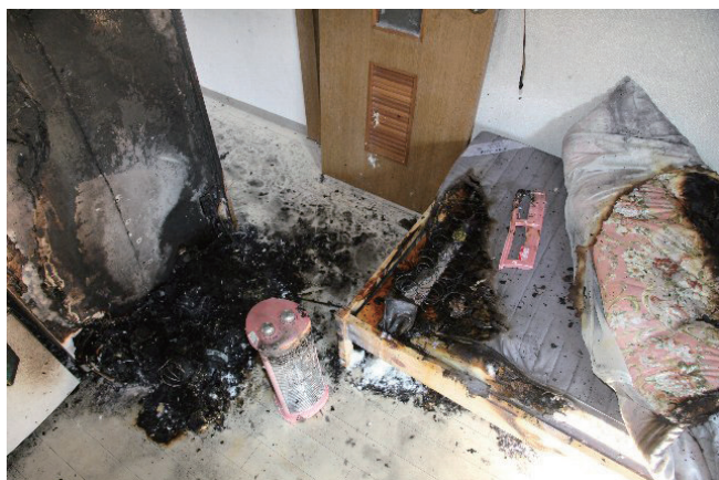
写真 6-1-1 出火室の焼損状況
