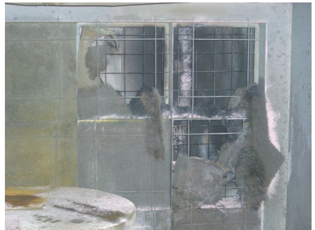
写真 6-7-4 集塵フィルタの焼損状況
