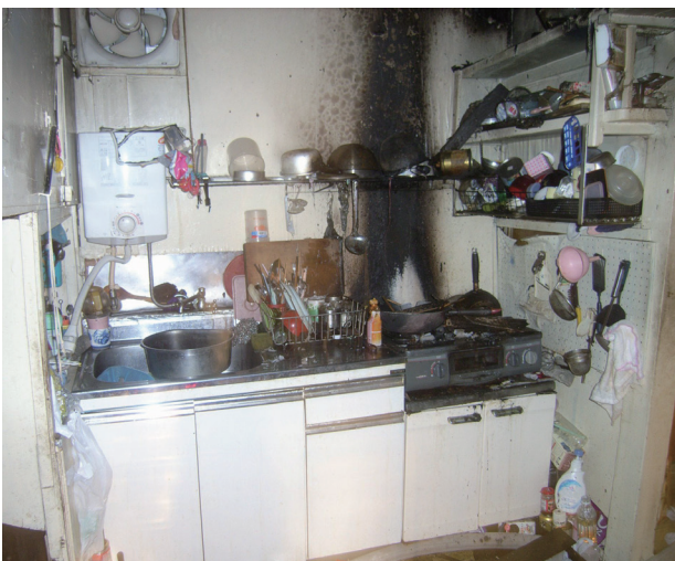
写真 6-1-3 台所の焼損状況
