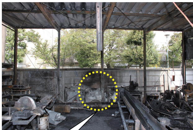
写真 2-1-4 作業場内の焼損状況
