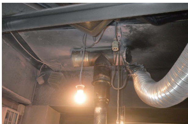
写真 6-2-2 ダクトの焼損状況
