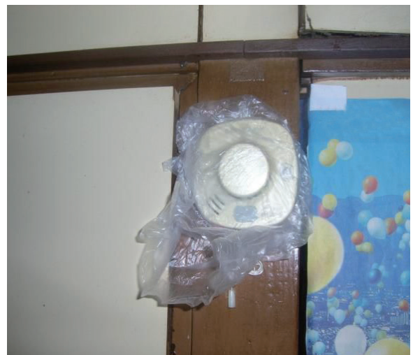
写真 6-1-4 感知しなかった住警器の状況
