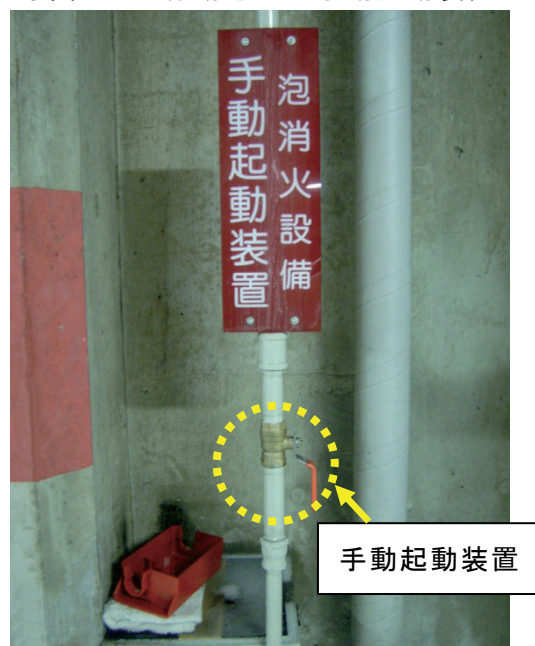
写真 7-2 作動させた手動起動装置
