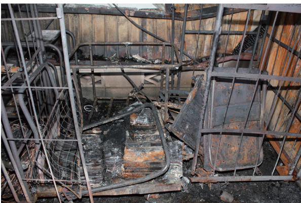
写真 6-8-3 台車付近の焼損状況
