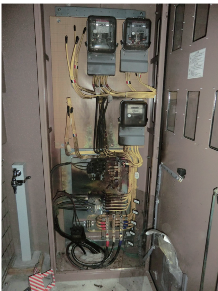
写真 5-2-3 引込開閉器盤の焼損状況
