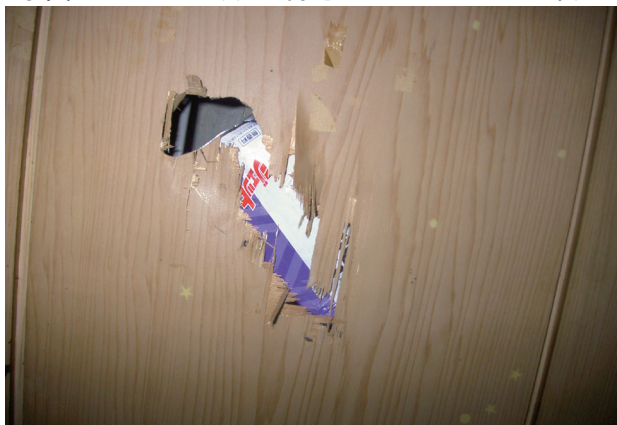
写真 3-3-1 天井に刺さったエアゾール缶の状況
