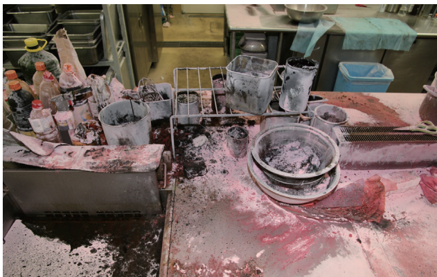
写真 6-6-3 調理室内の焼損状況
