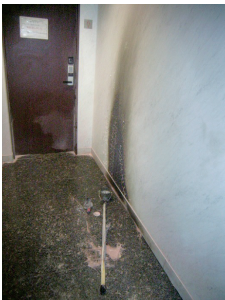
写真 5-3-3 出火箇所の状況
