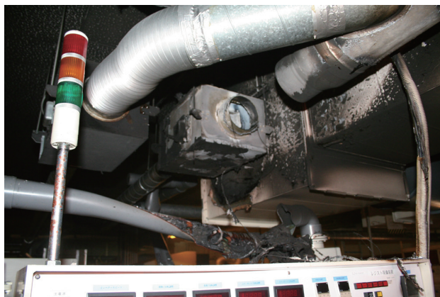
写真 6-7-1 排気ファンの焼損状況
