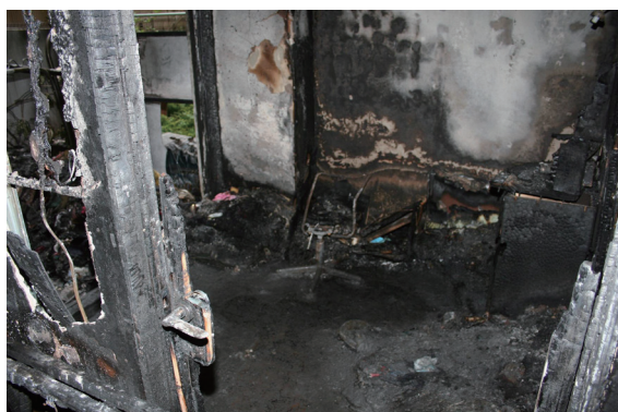
写真 2-3-1 出火室の状況
