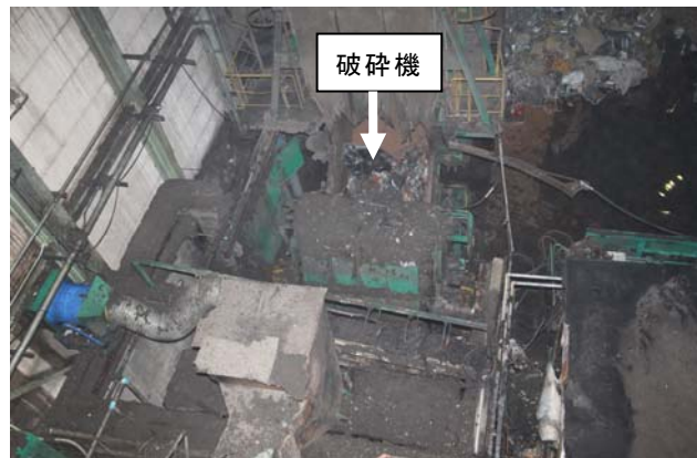
写真 6-12-4 破碎機周囲の焼損状況
