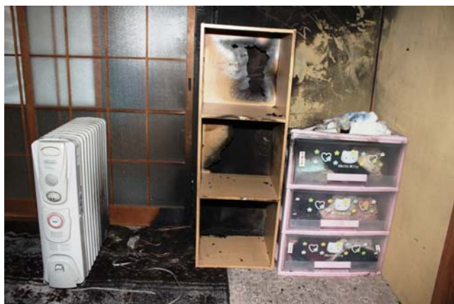
写真 6-1-1 建物の焼損状況
