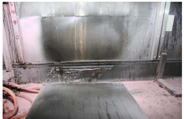
写真 6-13-4 キッチンカーの焼損状況
