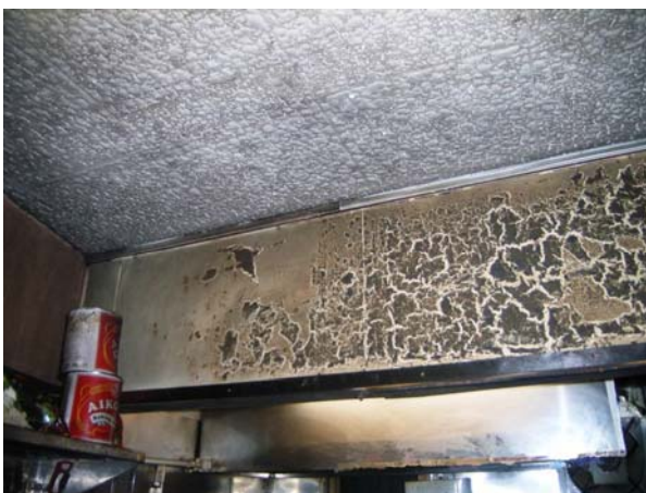
写真 3-1-3 厨房内の焼損状況
