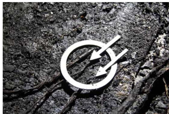
写真 6-9-3 差込みプラグの状況
