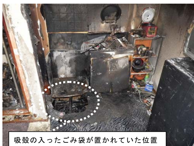
写真 2-2-3 出火室の焼損状況
