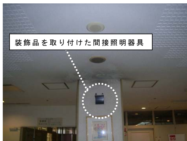
写真 6-5-3 出火した間接照明周辺の状況
