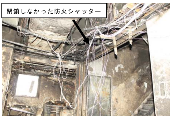
写真 8-3 出火箇所付近の状況
