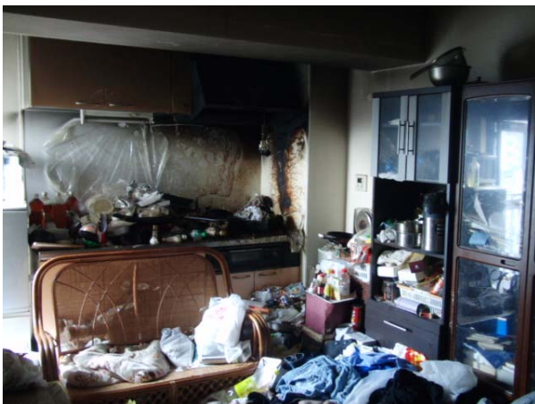
写真 6-1-9 台所の焼損状況
