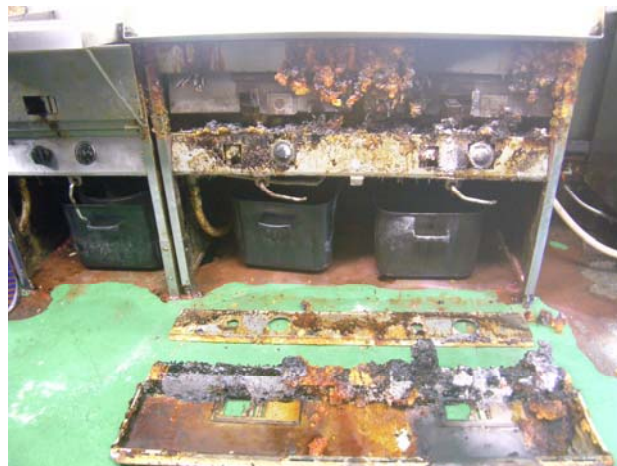
写真 2-7-2 油かすの堆積状況
