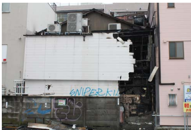
写真 2-2-2 建物の焼損状況
