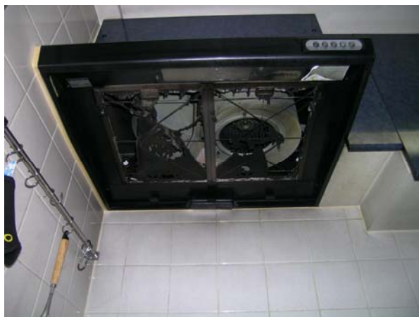
写真 3-1-2 レンジフードの焼損状況
