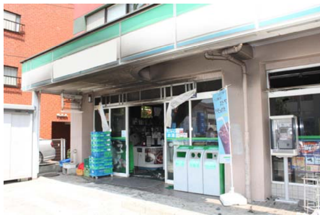
写真 6-3-1 出火建物の焼損状況
