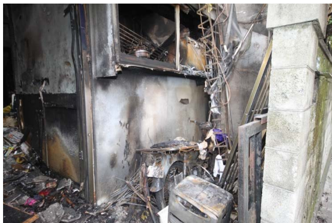
写真 2-1-2 外壁内部の焼損状況
