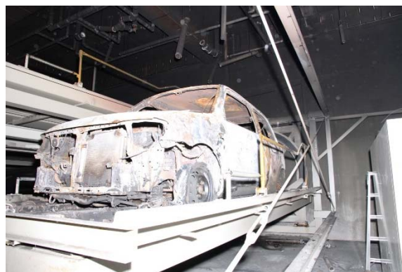
写真 7-2 屋内駐車場の焼損状況
