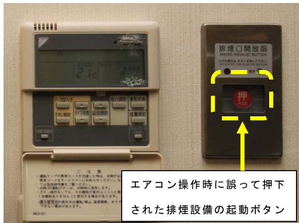
写真 6-10-2 排煙設備の起動ボタンの状況
