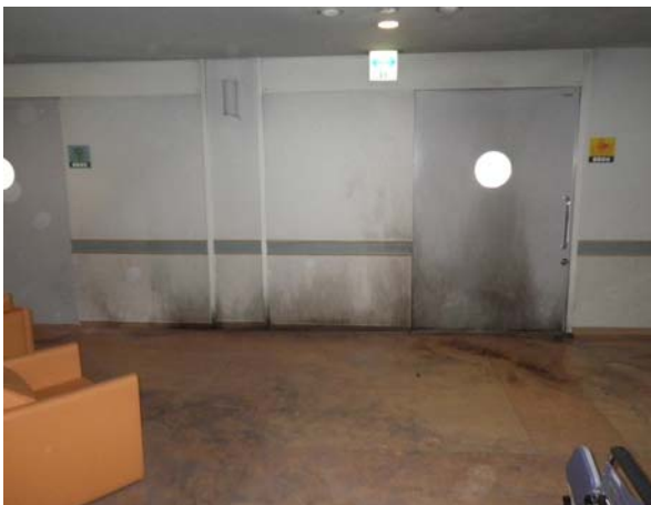
写真 2-1-4 8 階廊下の焼損状況
