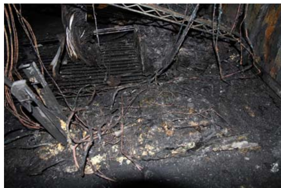
写真 6-9-2 出火場所付近の状況
