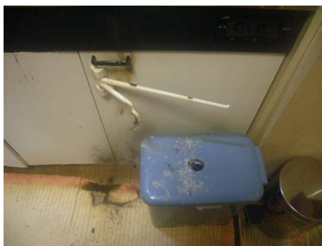
写真 5-1-4 タオル掛け等の焼損状況
