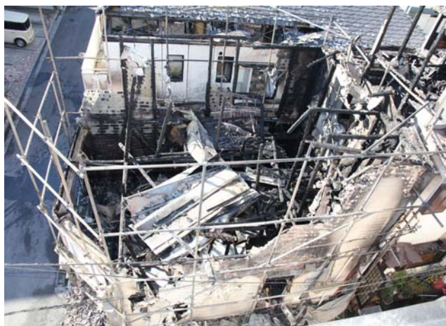
写真 5-2-2 建物の焼損状況
