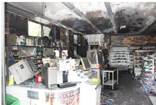
写真 6-3-2 店内の焼損状況
