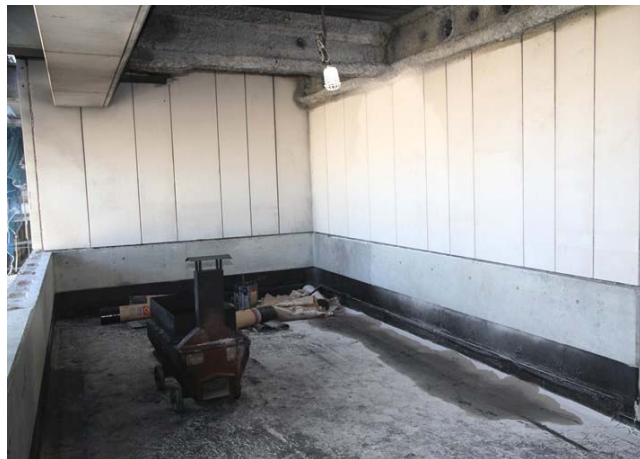
写真 2-8-2 出火箇所の状況
