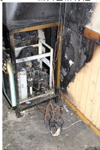
写真 2-6-4 出火箇所付近の状況
