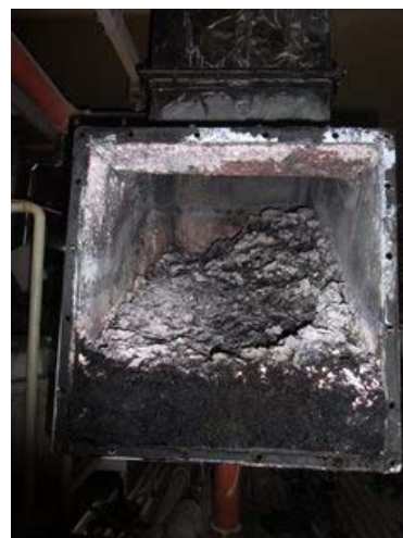
写真 6-7-2 ダクト内部に堆積した油かすの状況
