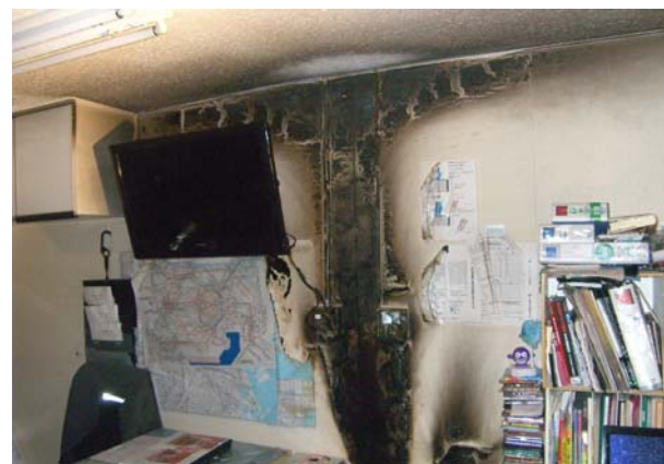
写真 6-9-6 焼損した壁体の状況
