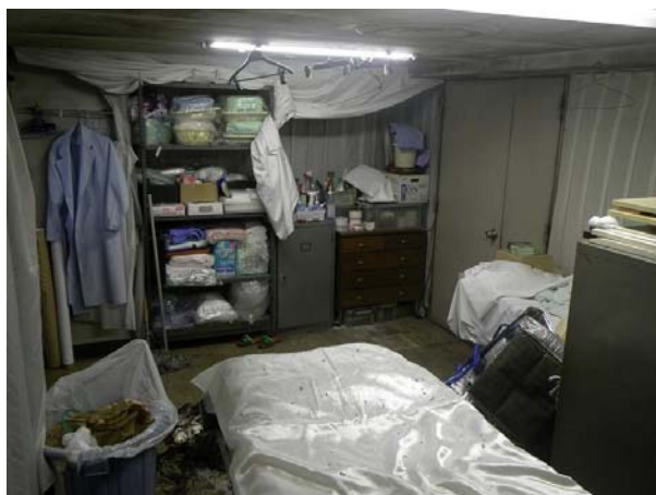
写真 6-5-1 出火室の焼損状況
