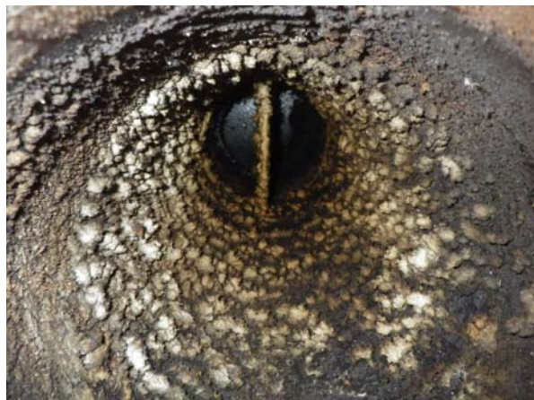
写真 6-10-1 厨房内のダクト状況
