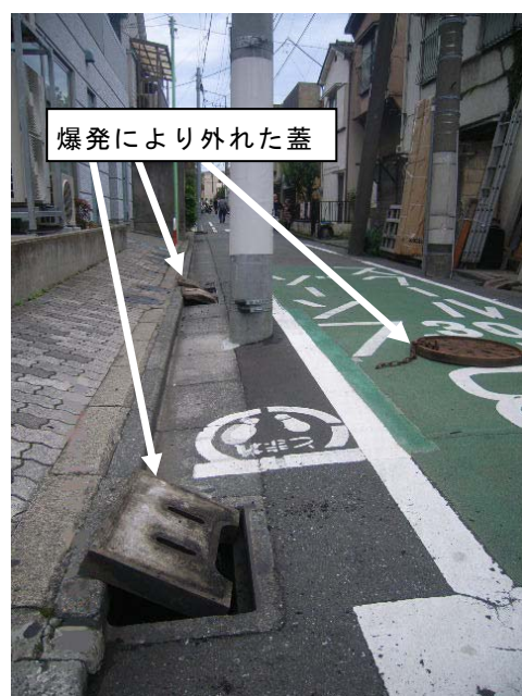
写真 3-2-4 出火箇所周囲の状況
