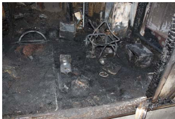
写真 5-1-2 出火室の状況
