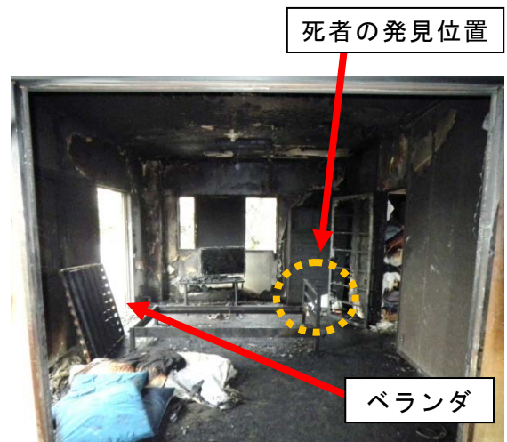
写真 4-3 類焼建物内部の状況
