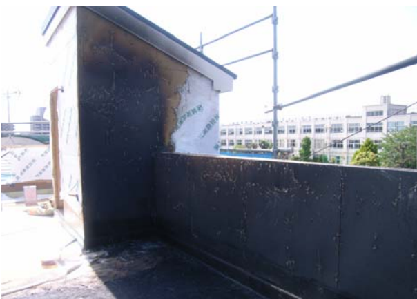
写真 5-2-3 ルーフバルコニーの焼損状況
