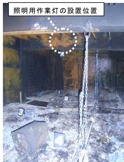
写真 3-2-2 出火箇所付近の焼損状況
