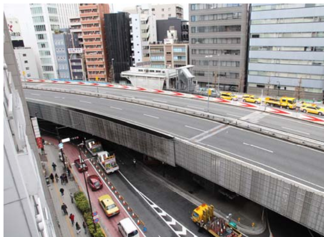
写真 3-2-1 高速道路の橋桁の焼損状況
