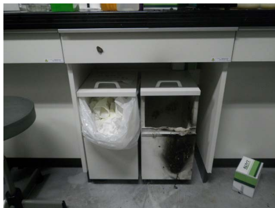
写真 6-6-4 出火したごみ箱の焼損状況
