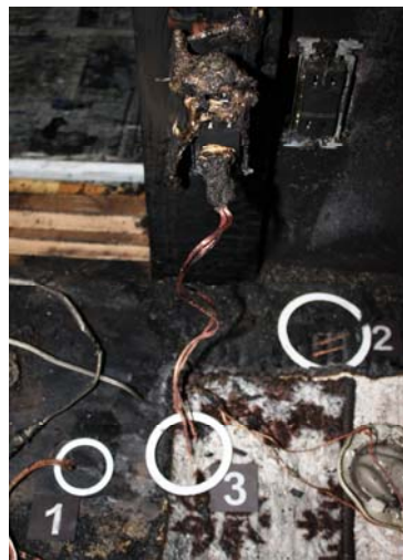
写真 6-1-2 出火箇所の状況
