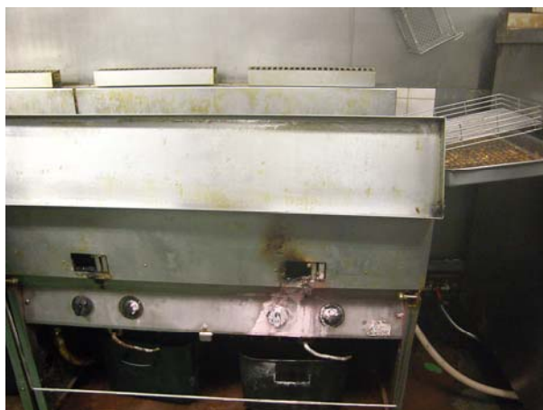
写真 2-7-1 ガスフライヤ外観の状況
