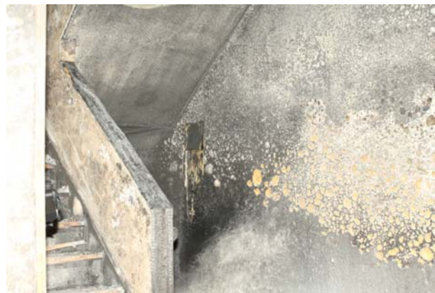
写真 8-4 延焼拡大した屋内階段の焼損状況
