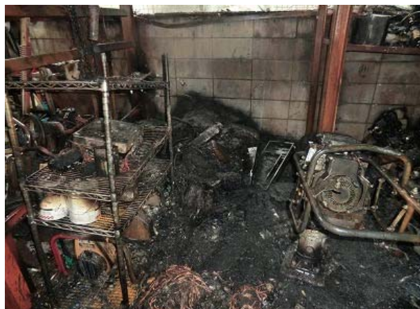
写真 6-8-1 出火箇所の状況
