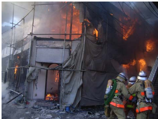
写真 5-2-1 延焼中の解体工事中建物の状況
