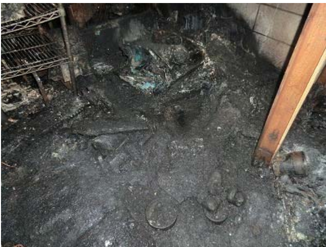
写真 2-4-1 樹脂製の箱が溶着している状況
