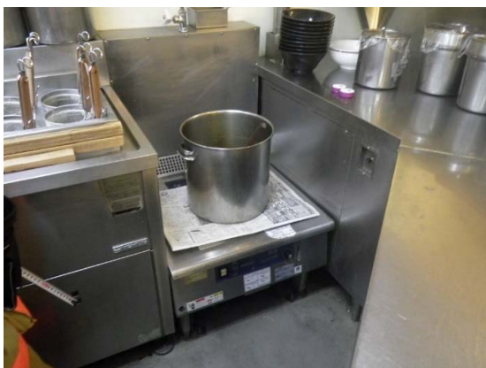
写真 6-6-1 出火した電磁調理器の状況
