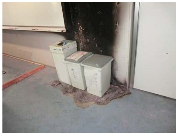
写真 3-2-2 焼損箇所を復元した状況
