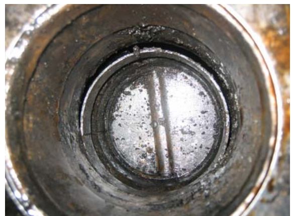
写真 6-2-5 防火ダンパーの作動状況
