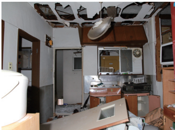
写真 3-4-1 出火室の破損状況
