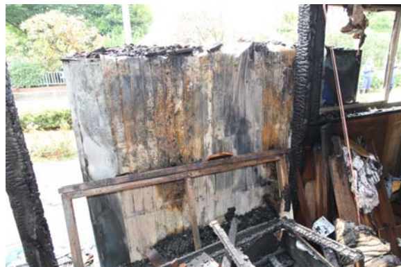
写真 2-1-3 自動販売機の裏面の状況
