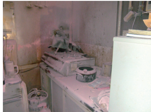
写真 3-1-3 ガステーブル付近の焼損状況
