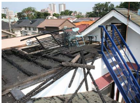
写真 2-5-2 屋上の焼損状況
