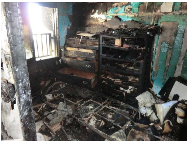
写真 2-4-1 出火した居室の状況
