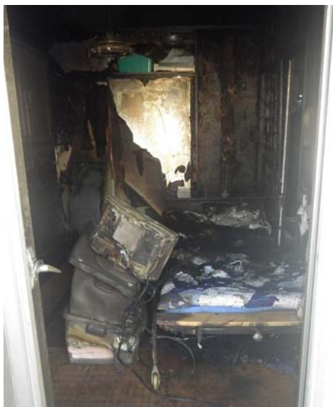
写真 2-2-1 出火室の状況
