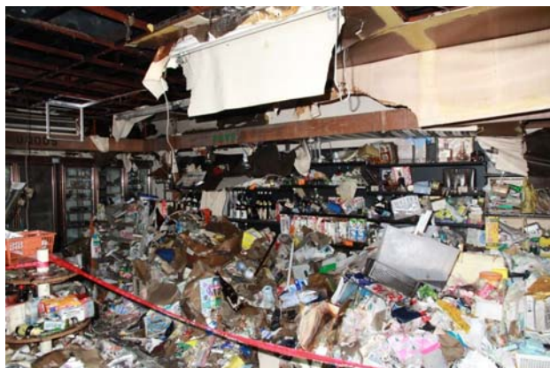
写真 6-3-1 店内の焼損状況
