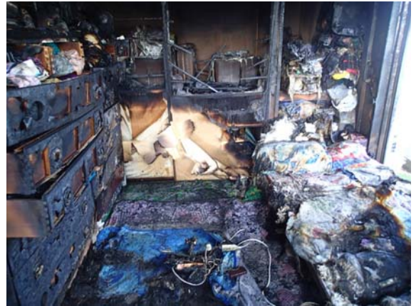
写真 6-1-4 出火室ベッドの焼損状況
