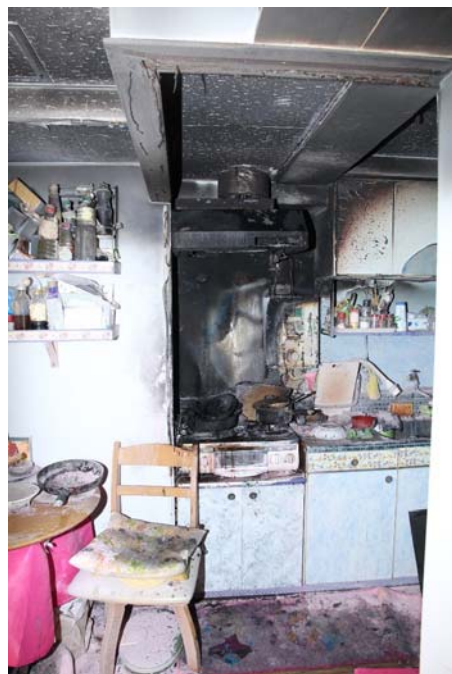
写真 3-1-1 台所の焼損状況
