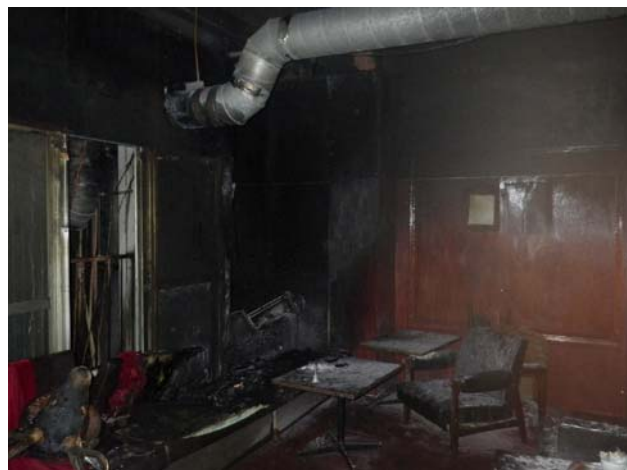
写真 8-2 延焼拡大した上階の焼損状況
