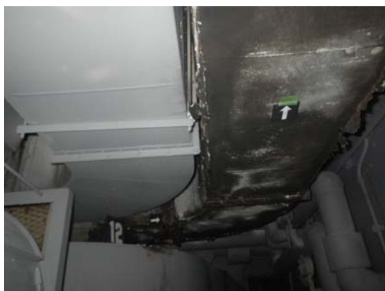
写真 6-4-4 屋上のダクトの延焼状況
