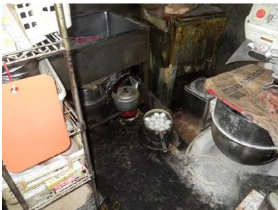
写真 5-3-1 大型ガスこんろの状況
