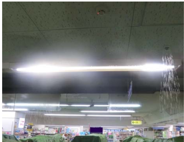
写真 6-3-4 スプリンクラーの作動状況
