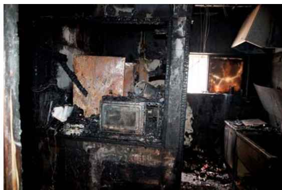
写真 6-9-2 出火場所付近の状況
