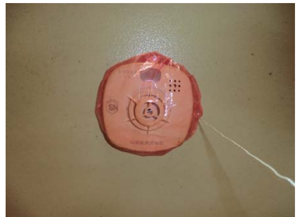
写真 6-1-9 住宅用火災警報器の設置状況
