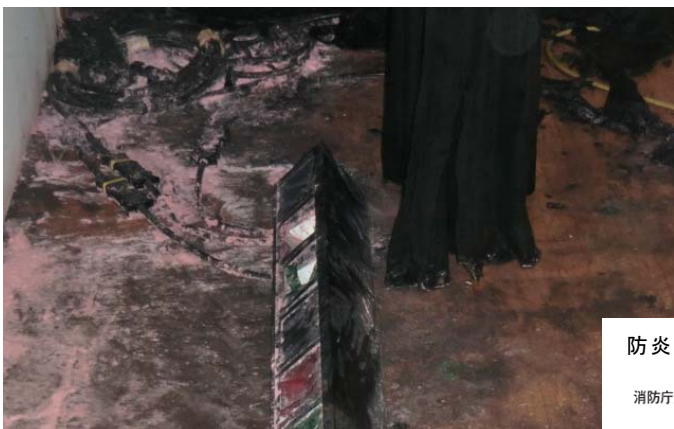
写真 6-10-3 舞台上の幕及びライト焼損状況
