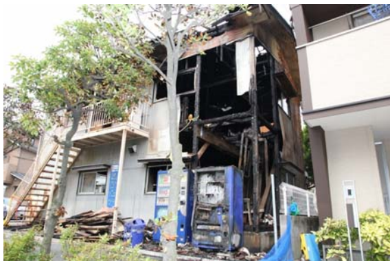
写真 2-1-2 出火箇所付近の状況
