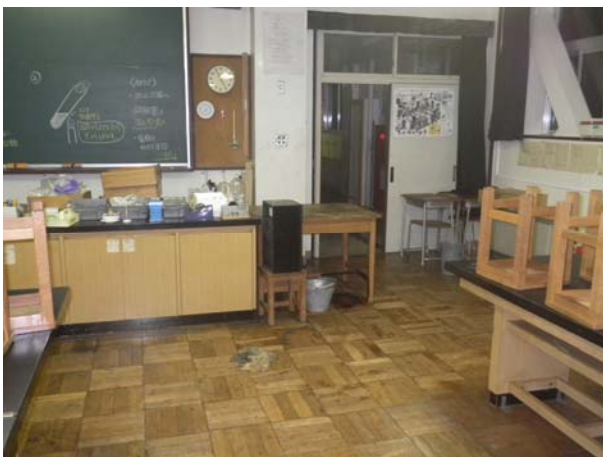
写真 6-6-3 理科室内の焼損状況
