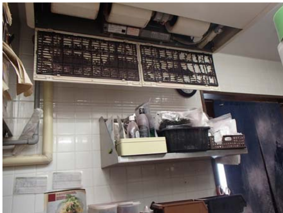
写真 2-8-2 エアコンフィルターの焼損状況
