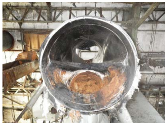
写真 6-12-4 焼損している排気ダクト
