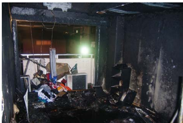
写真 2-3-1 出火室の状況
