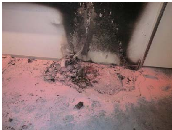
写真 3-2-1 焼損箇所の状況
