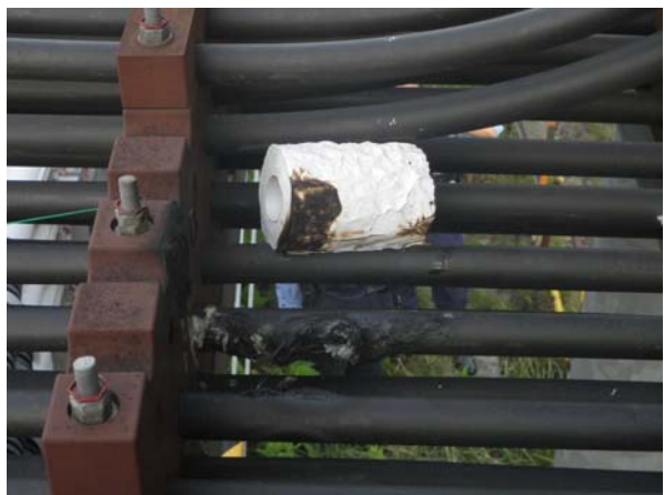
写真 2-1-6 ケーブル上の焼損物件
