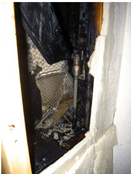
写真 5-2-3 出火箇所の焼損状況
