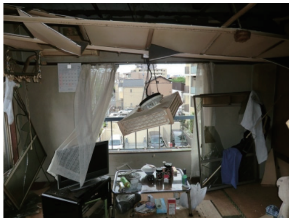
写真 3-4-2 別室の破損状況
