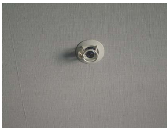
写真 6-1-7 スプリンクラーヘッドの状況
