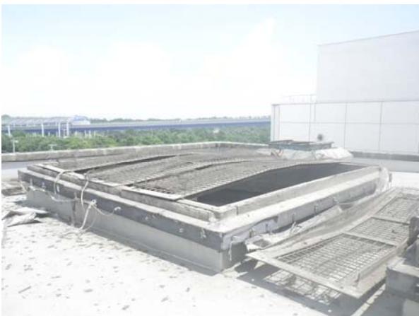
写真 3-4-3 破損した屋根の状況
