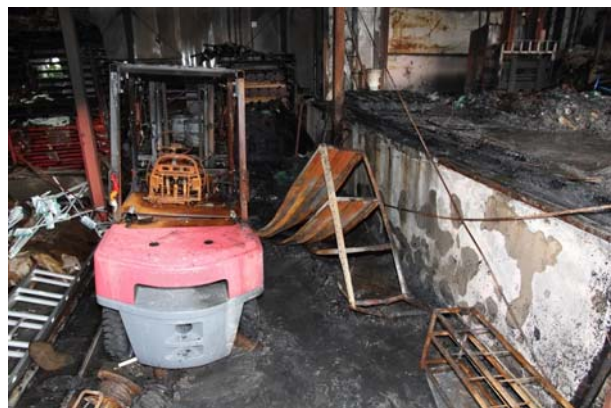
写真 6-8-4 出火箇所付近の状況
