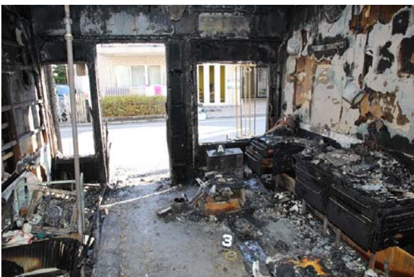
写真 5-1-3 出火室の焼損状況
