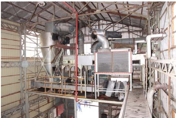
写真 6-12-3 焼損したプラント
