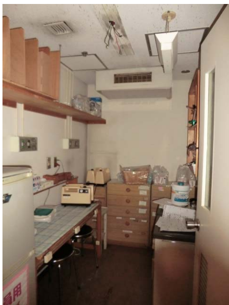
写真 6-5-1 出火室の状況
