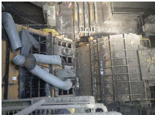
写真 3-4-4 破砕機の状況
