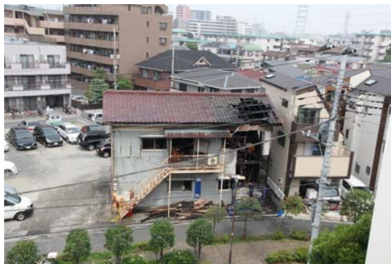
写真 2-1-1 出火建物と周囲の状況
