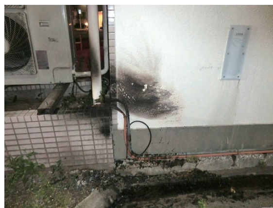
写真 2-1-2 焼損した外壁
