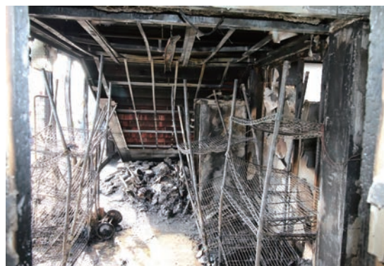
写真 8-1 階段下倉庫焼損状況
