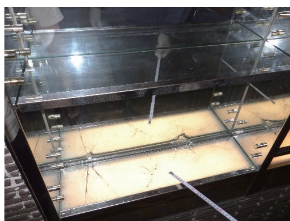
写真 3-4-2 破損したガラス棚の状況
