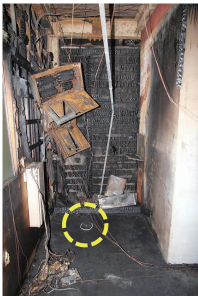
写真 6-1-1 動力用分電盤の状況
