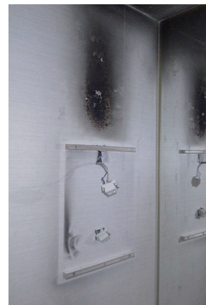
写真 6-4-1 内壁の焼損状況
