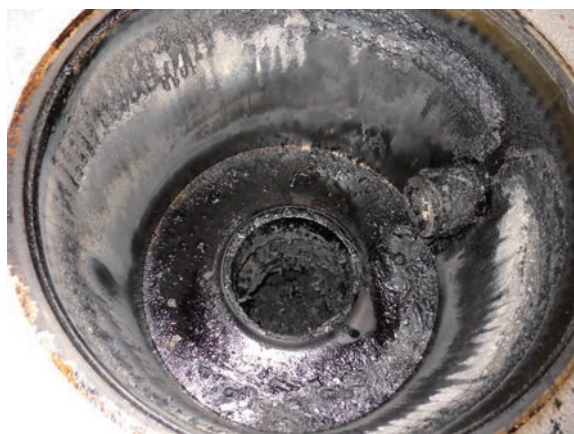
写真 6-2-4 無煙ロースタ内の状況
