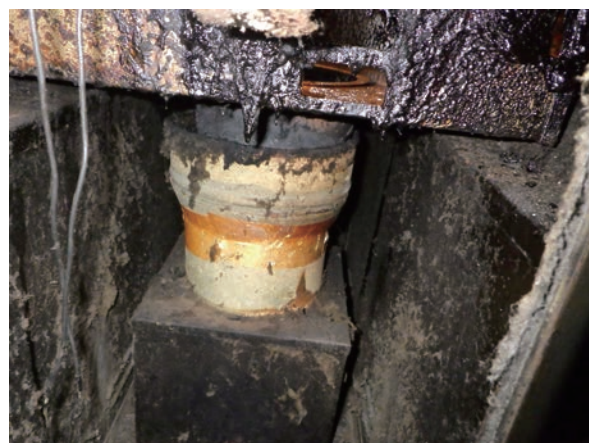
写真 6-2-5 防火ダンパーの設置状況
