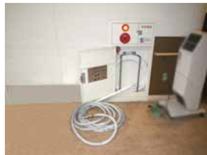
写真 32-2 補助散水栓の状況
