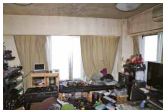
写真 31-1 出火室の状況
