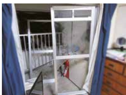
写真 12-2 サッシの破損状況
