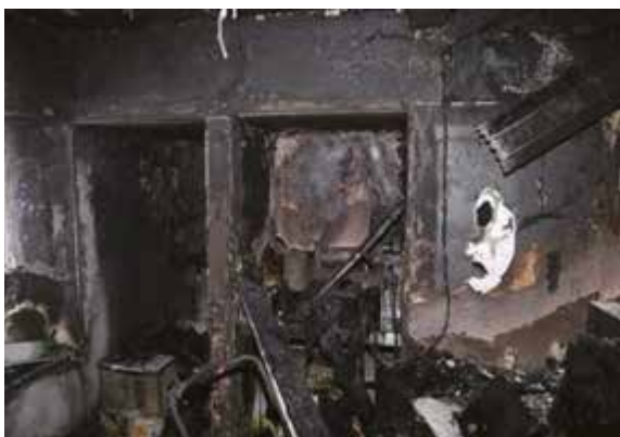
写真 2-1 出火室の状況
