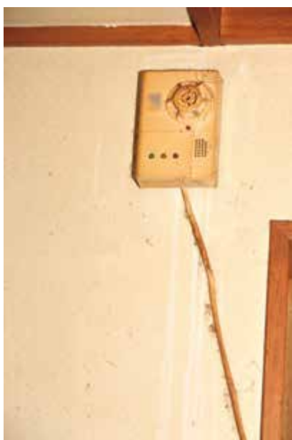
写真 19-3 1階台所の複合型住警器の 設置状況
