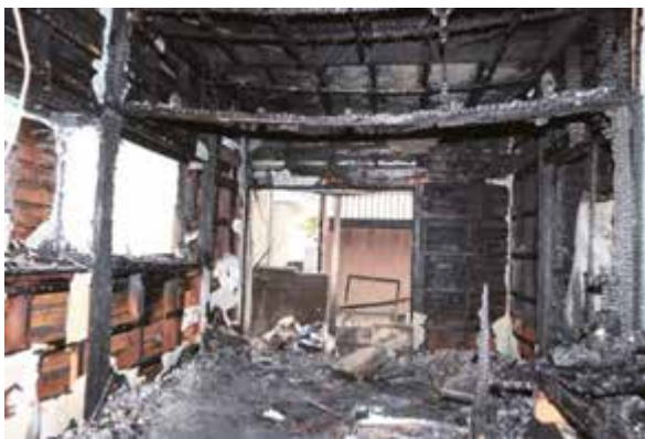
写真 2-3 出火した居室
