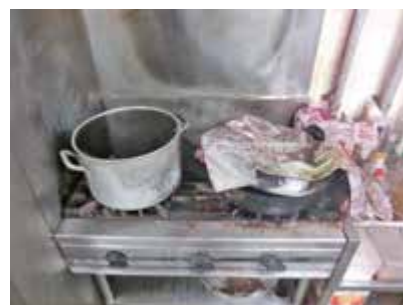
写真 28-1 大型ガスこんろの状況
