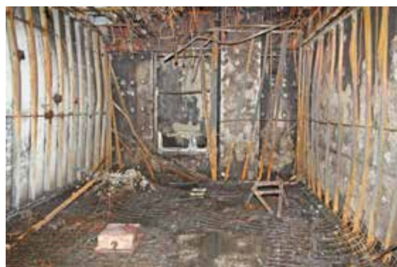
写真 16-1 出火箇所の状況
