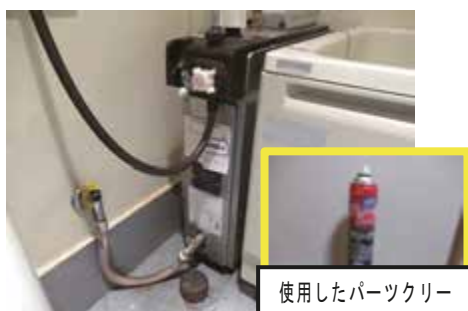
写真 12-1 バランス風呂釜の状況
