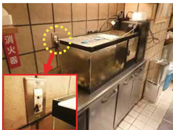
写真 6-1 壁付コンセント周辺の焼損状況
