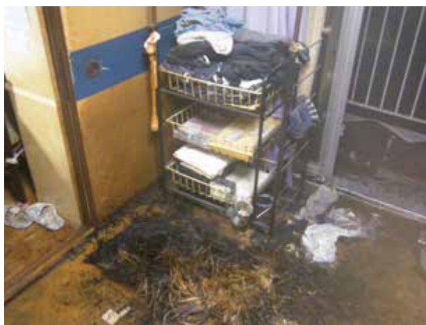
写真 14-1 焼損した居室の状況
