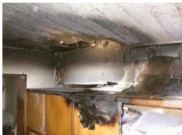
写真 12-6 天井の焼損状況
