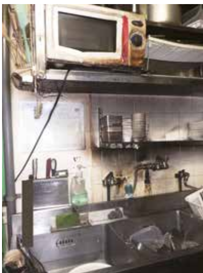
写真 11-3 調理場の焼損状況
