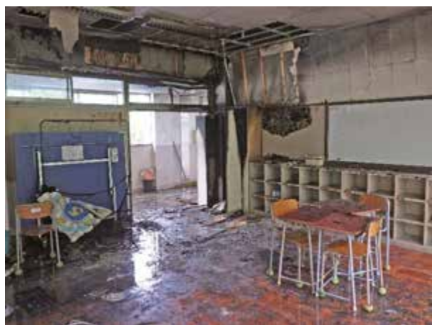
写真 24-4 教室内の状況
