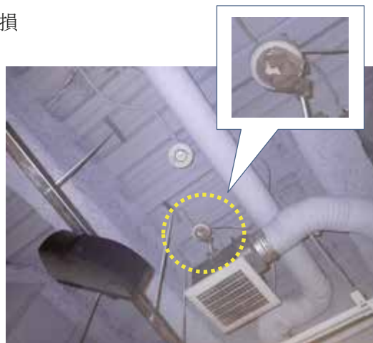
写真 31-3 覆われた感知器の状況
