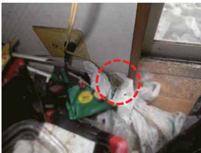
写真 19-4 外れている電源プラグの状況
