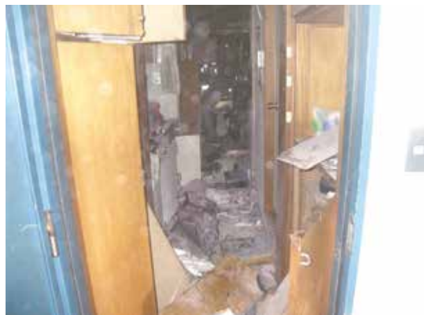
写真 12-4 玄関の焼損状況
