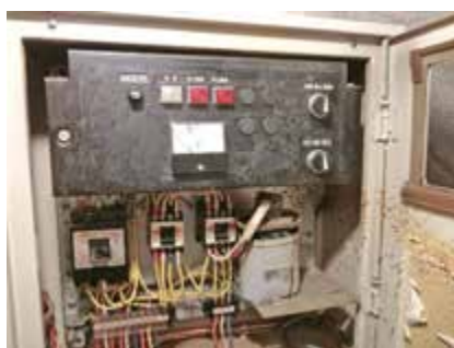
写真 26-2 操作盤の状況
