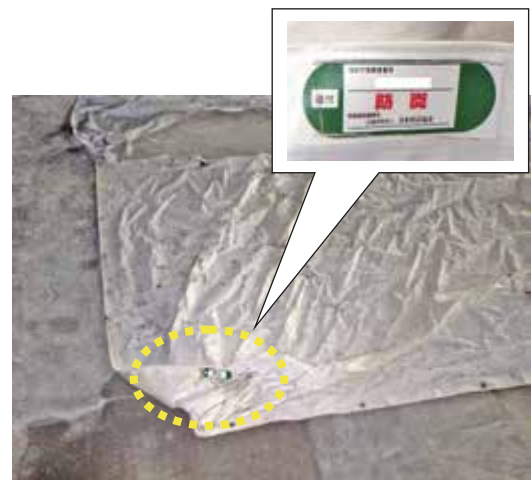
写真 18-2 防災シートの焼損状況
