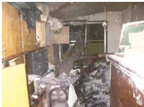
写真 12-5 居室の焼損状況
