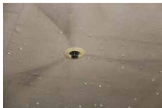
写真 31-2 スプリンクラーの作動状況
