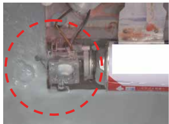
写真 11-2 水中に漏れたLPガスの気泡
