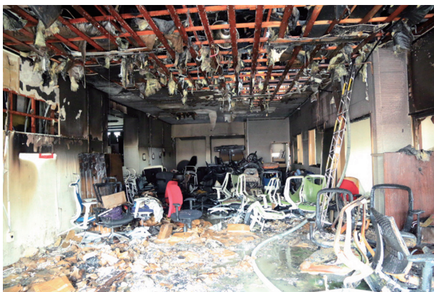
写真 26-1 倉庫内の焼損状況
