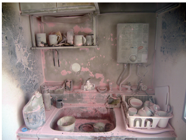
写真 11-3 出火室の状況
