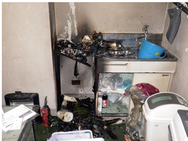
写真 2-1 出火室の焼損状況
