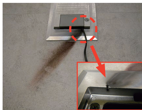
写真 27-2 フロアコンセントの状況
