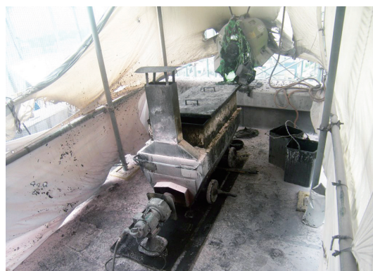
写真 16-2 焼損箇所の状況
