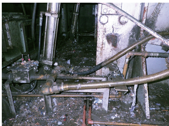
写真 31-4 出火箇所付近の状況
