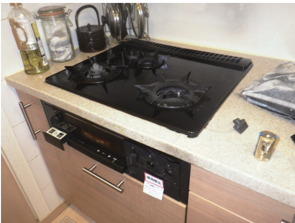
写真 7-1 ガステーブル周辺の状況
