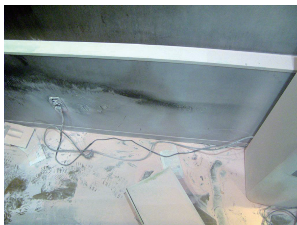
写真 23-4 ソファ裏の焼損状況
