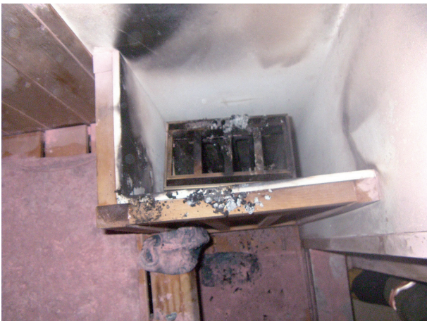
写真 22-1 焼損したサウナヒータの状況
