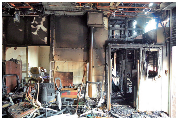
写真 26-2 台所付近の焼損状況
