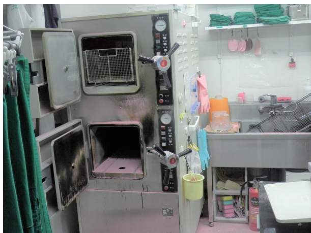
写真 23-1 滅菌器の焼損状況
