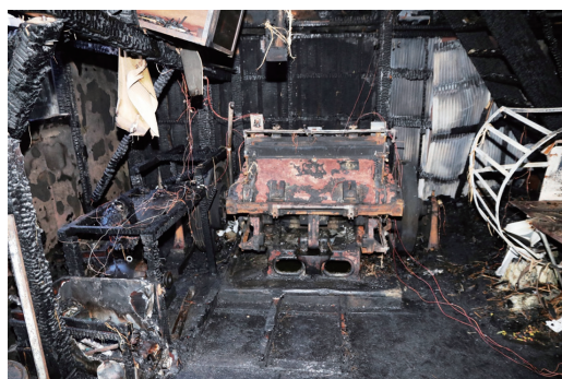
写真 14-4 低圧進相コンデンサが設置されていた箇所の状況
