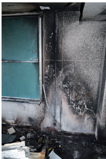
写真 24-1 焼損した内壁
