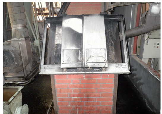
写真 25-1 焼却炉の状況
