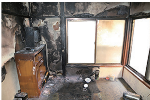
写真 2-3 出火室の焼損状況
