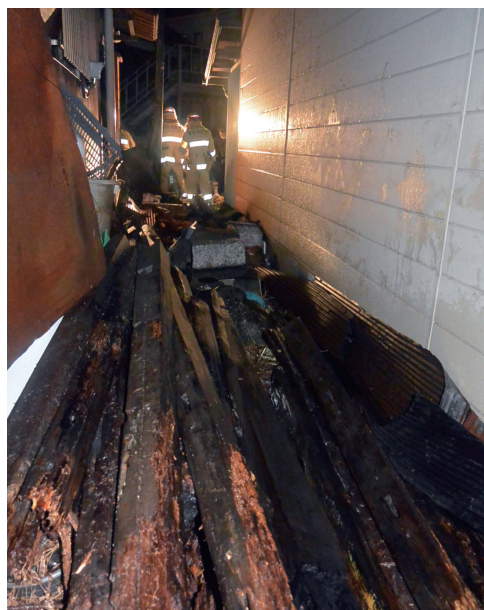
写真 1-2 出火箇所の焼損状況
