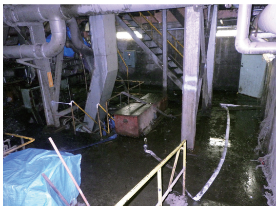
写真 31-3 延長した屋内消火栓設備の状況
