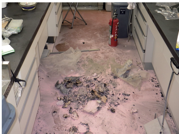
写真 29-1 出火室の焼損状況
