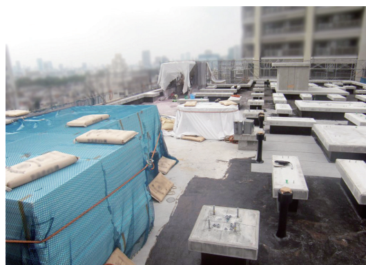
写真 16-1 出火箇所の状況
