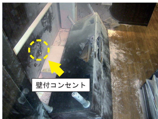
写真 23-3 ソファ等の焼損状況
