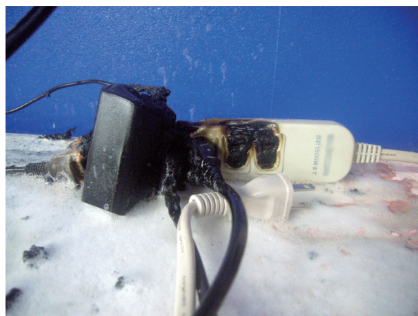
写真 28-2 出火箇所の状況
