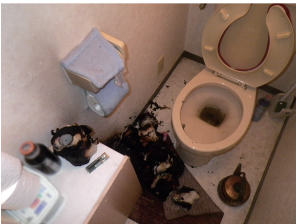
写真 4-3 トイレの状況
