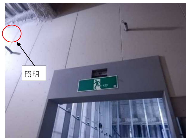
図 3 - 12 避難口誘導標識及び近傍に設置した照明
