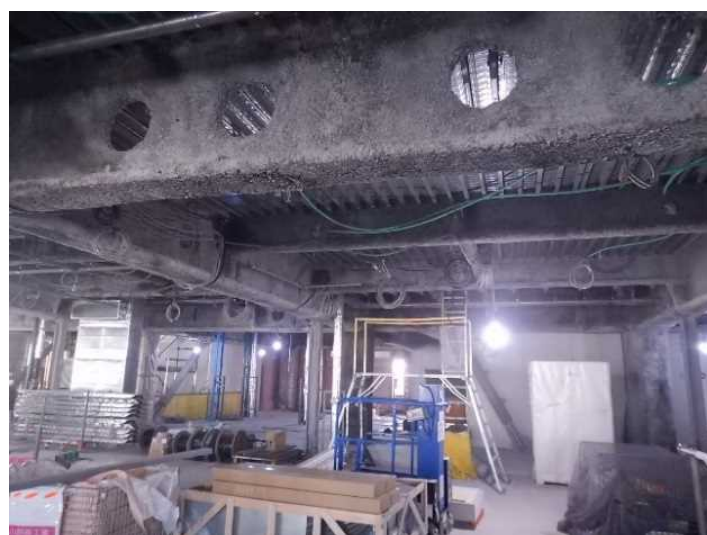
図 3 - 13 工事現場内 作業中のフロアに設置した照明
