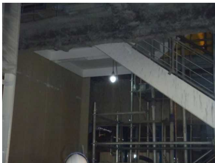
図 3-14 工事現場内の階段に設置した照明
