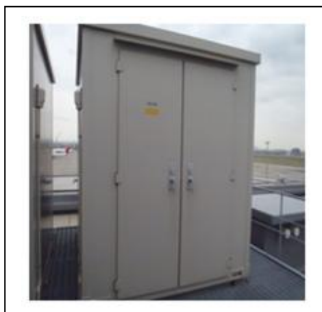
写真 2-1 パワコン（屋外）
