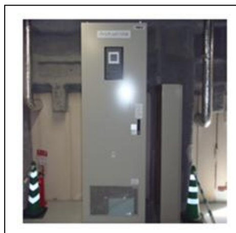
写真 2-2 パワコン（屋内）
