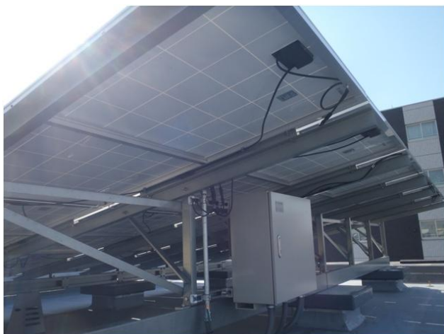
写真 7-16 表示が緩和される例 (PVモジュールと近接している接続箱)
