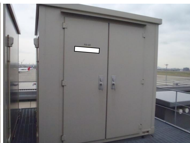
写真 7-5 屋外用パワコンキュービクルの例
