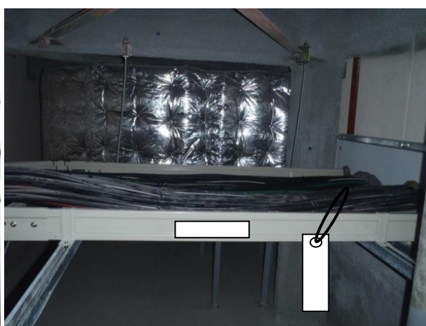
写真 7-11 E P S内配線ラックの例
