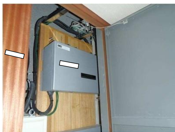
写真 7-6 EPS 扉内パワコンの例
