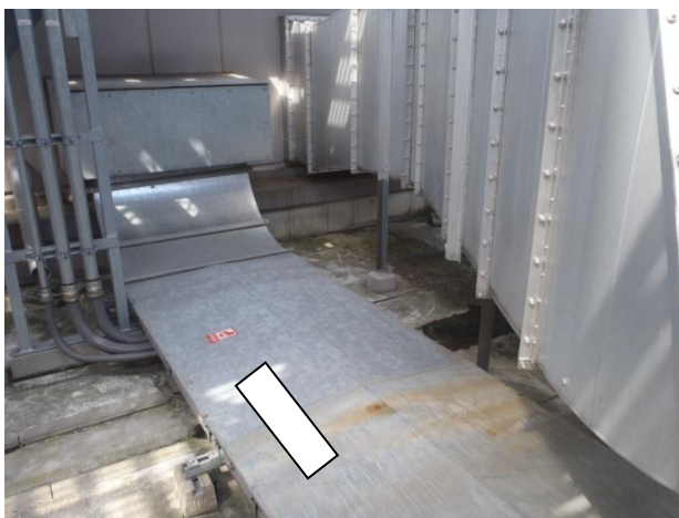
写真 7-10 屋上ケーブルダクトの例
