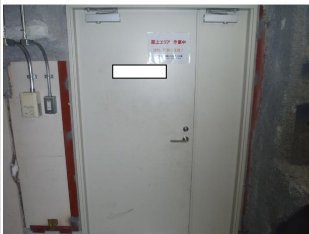
写真 7-13 パワコン設置室（電気室）入口の例
