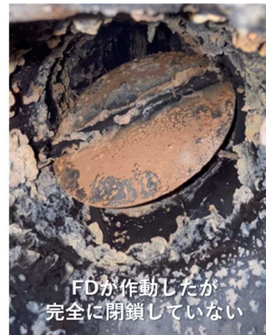
写真 2 - 9 防火ダンパー
