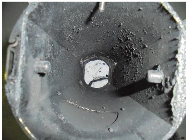
写真 5－12 鎮火後、ダクト内部の状況（着火有）
