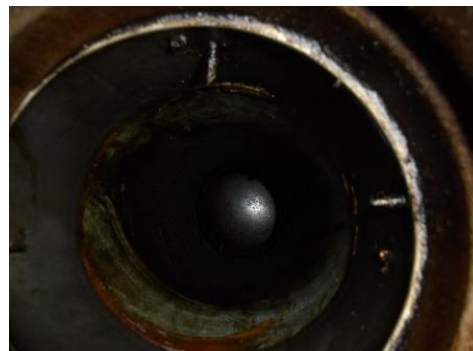
写真 5-15 店舗E 上引きダクト
