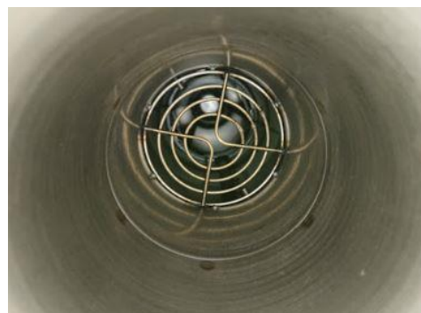
写真 5 - 7 店舗 B 上引きダクト
