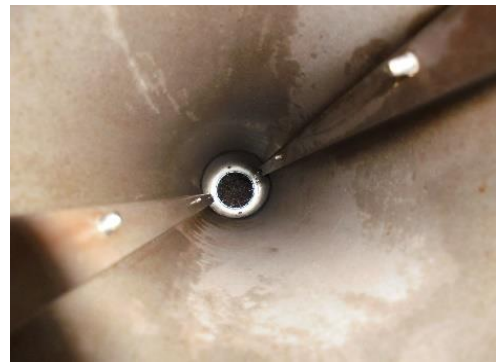
写真 5-21 店舗 G 上引きダクト
