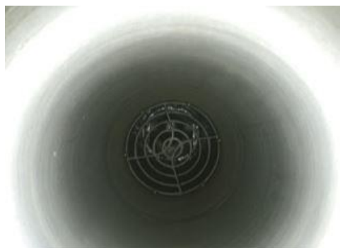
写真 5-10 店舗C 上引きダクト
