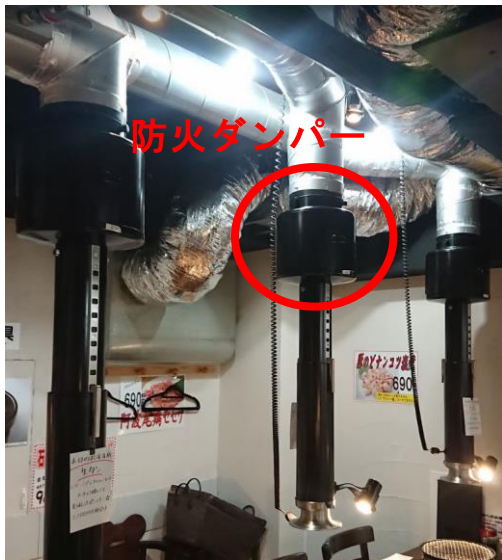
写真 5 - 2 防火ダンパー
