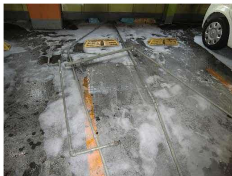
泡流出事故の例
