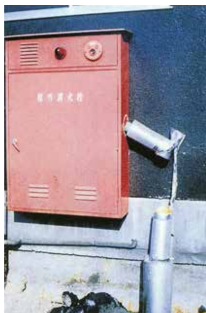
屋外消火栓設備の被害例
