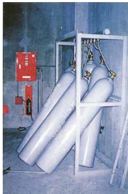
ハロゲン化物消火設備の被害例
