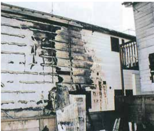
焼損部分の撮影
