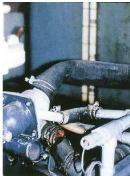
冷却水用配管の被害例
