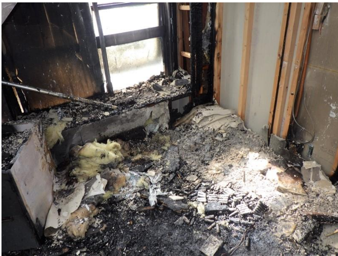
①出火した居室の焼損状況（3月）
