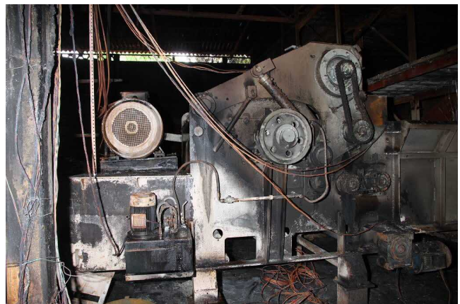
写真 28-2 破碎機の焼損状況
