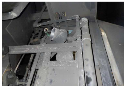
写真 30-3 二酸化炭素消火設備の状況
