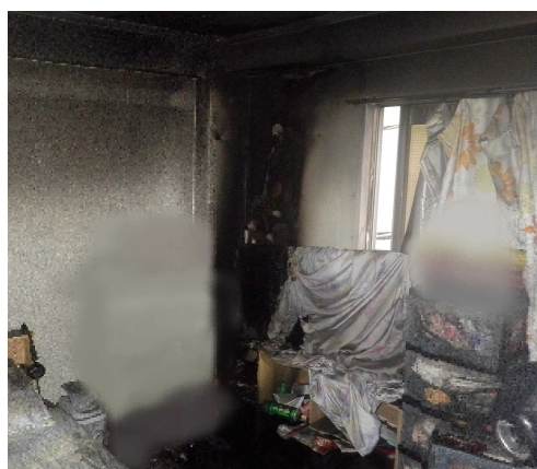
写真 31-1 出火室の状況
