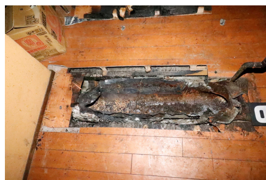
写真 19-4 客席下ダクトの焼損状況
