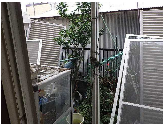
写真 12-1 爆発による窓ガラス等の破損状況
