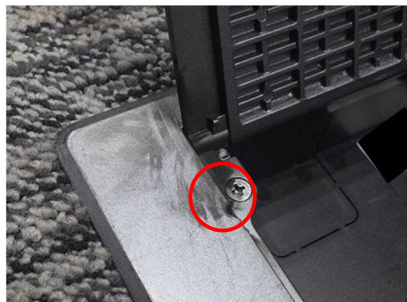
写真 26-4 フロアコンセント付近の焼損状況
