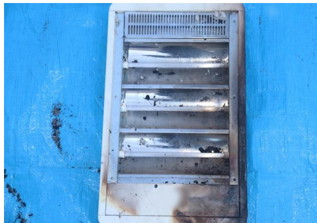
写真 18-2 電気ストーブの焼損状況
