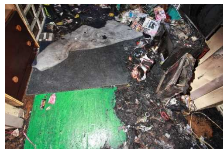
写真 11-2 居室の焼損状況
