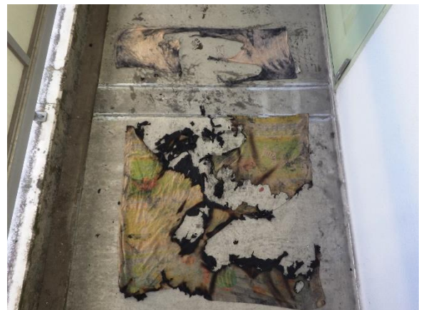
写真 6-2 焼損したタオルの状況
