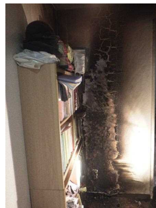
写真 13-1 焼損した居室の状況
