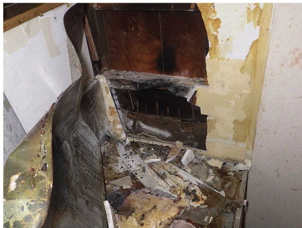
写真 7-4 壁体内の焼損状況
