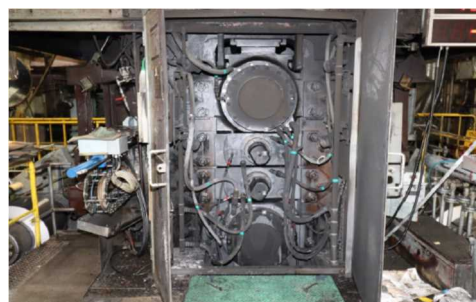
写真 30-2 出火箇所付近の状況
