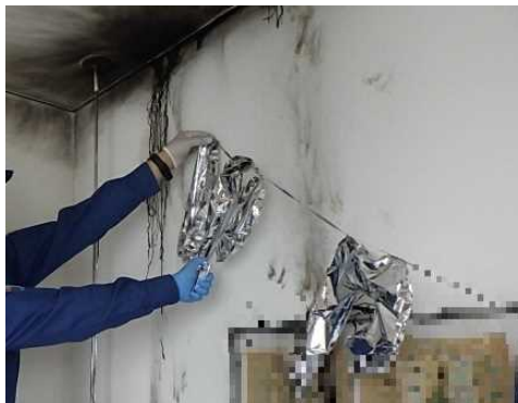
写真 21-2 出火時の再現状況
