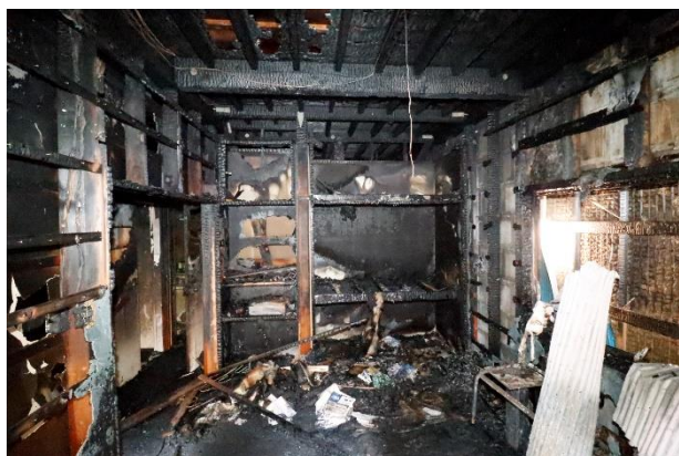
写真 6-3 居室の焼損状況
