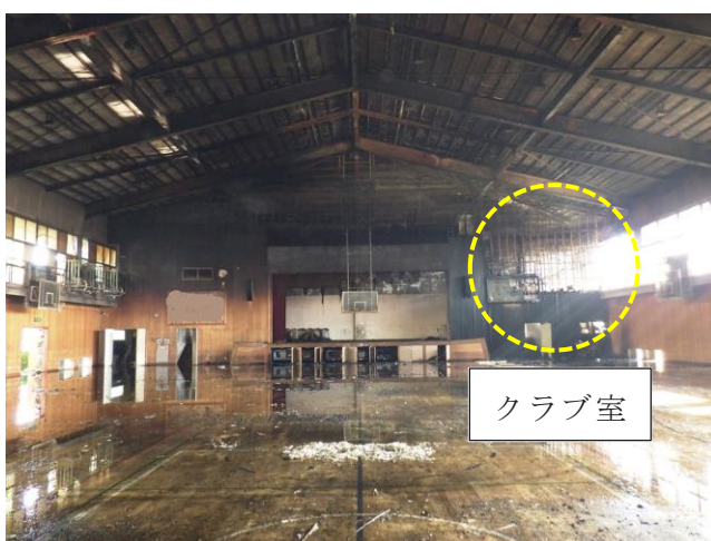
写真 23-1 体育館の焼損状況
