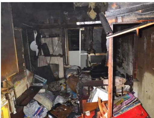
写真 14-6 居室内の焼損状況
