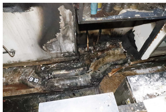
写真 19-5 ダクト内の焼損状況
