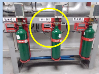
操作管に閉止弁を設置した例
