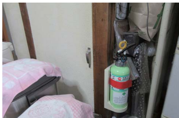
全住戸に住宅用消火器を配置
