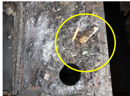
写真8 携帯型扇風機の焼損状況
