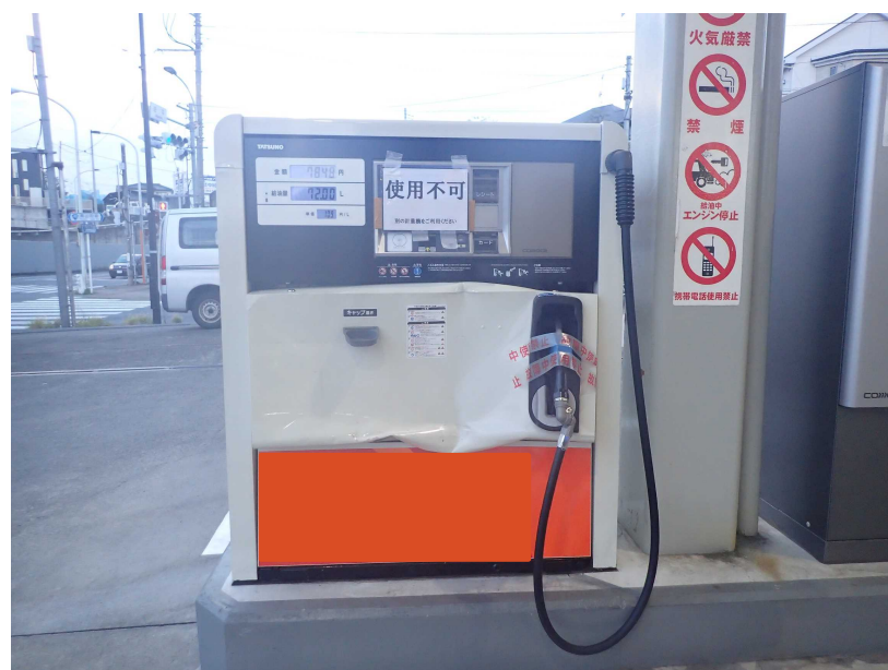
注油設備の破損状況
