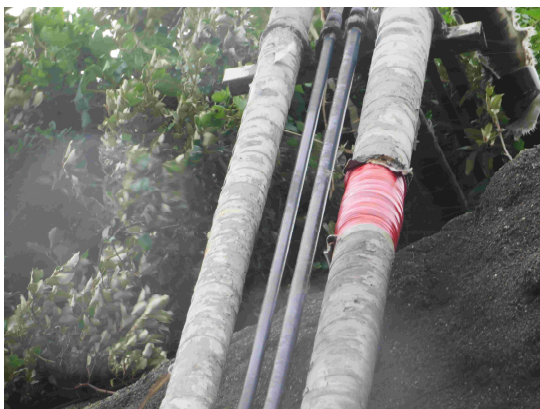
損傷した配管の応急措置
