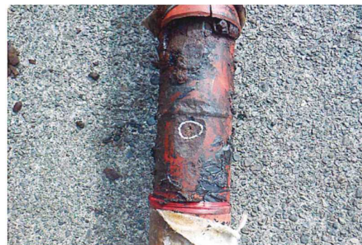
配管の腐食状況
