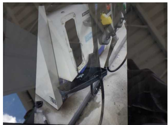
固定給油設備の破損状況
