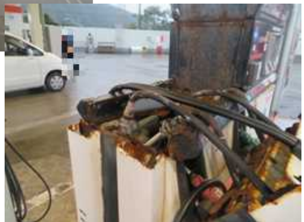
転倒した固定給油設備
