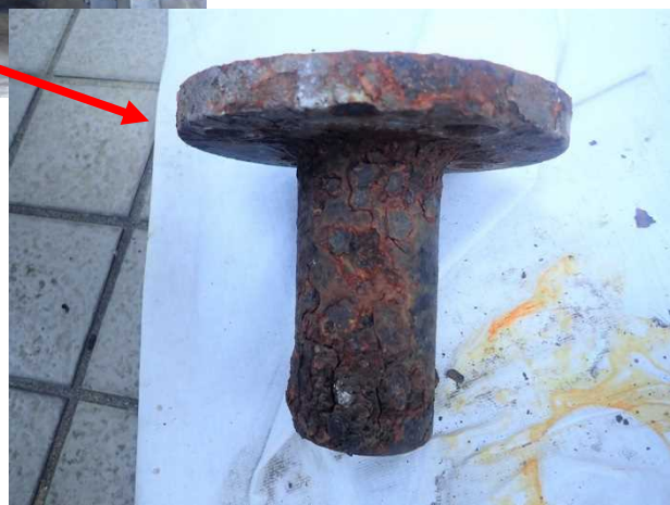
錆びが認められた配管
