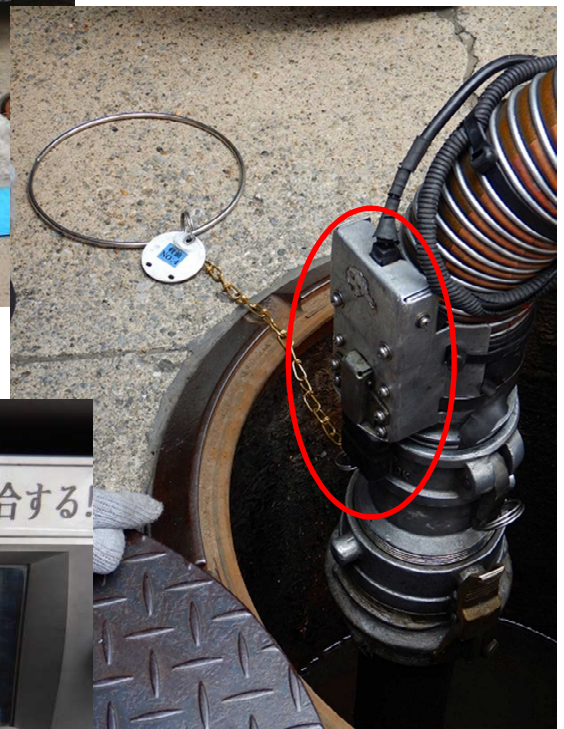
油種キーの設置状況
