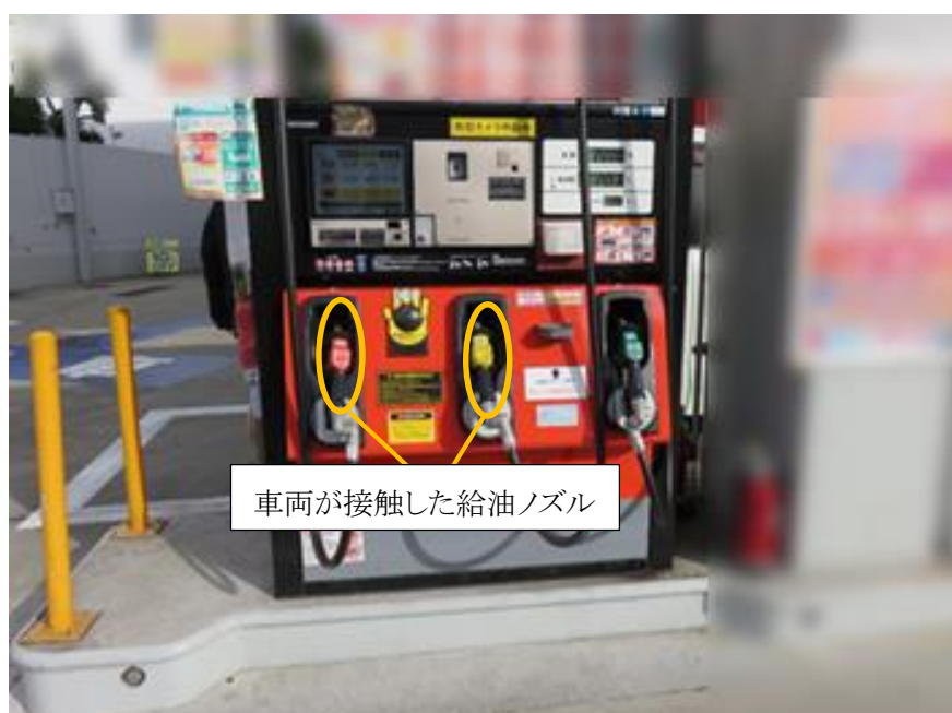
車両が接触した固定給油設備の状況（給油ノズル補修後）
