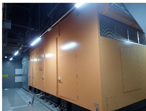
区画室設置の非常用発電設備（一般取扱所）
