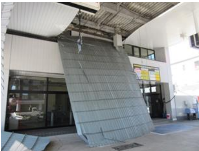
強風で剥離落下したキャノピー天井の一部
