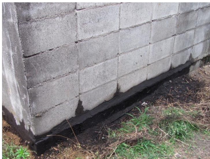
燃料庫外への流出状況
