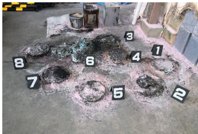
塗料、ポリバケツ等の焼損状況
