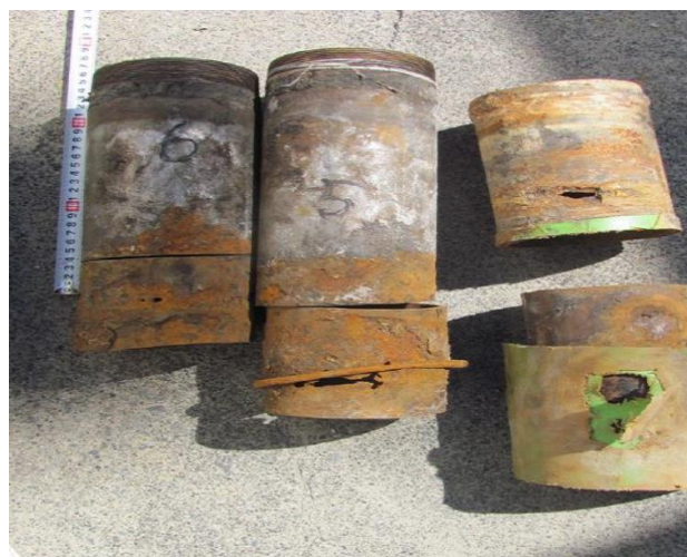
取り出した配管の腐食状況
