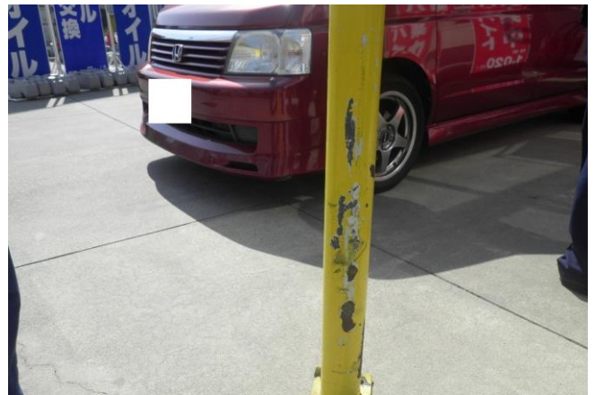
ガードポールの破損状況
