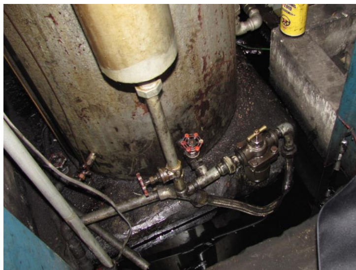
燃料庫内の流出状況
