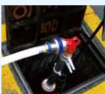
スタンドパイプとホースをつなぐ
