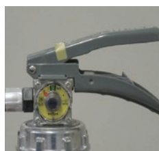
× 安全栓の脱落
