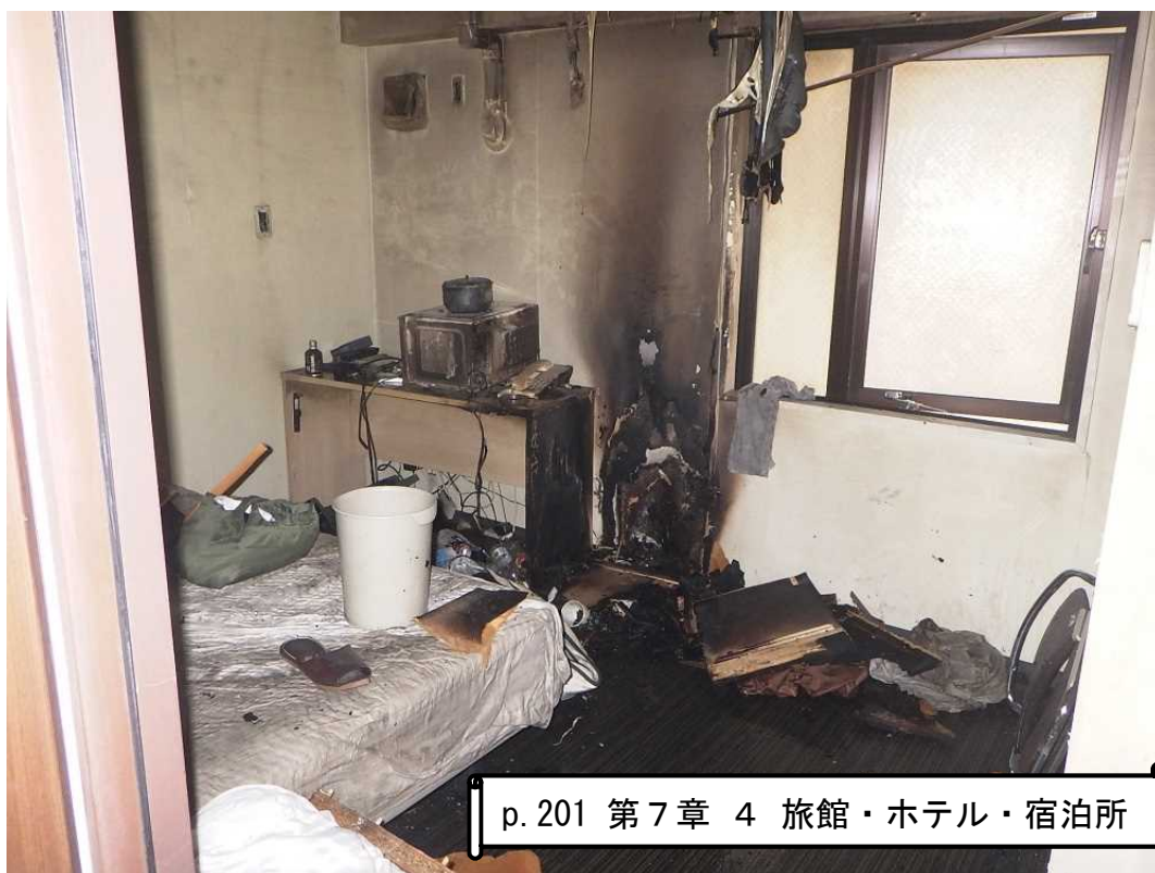
ホテル客室から出火した火災（8月）
