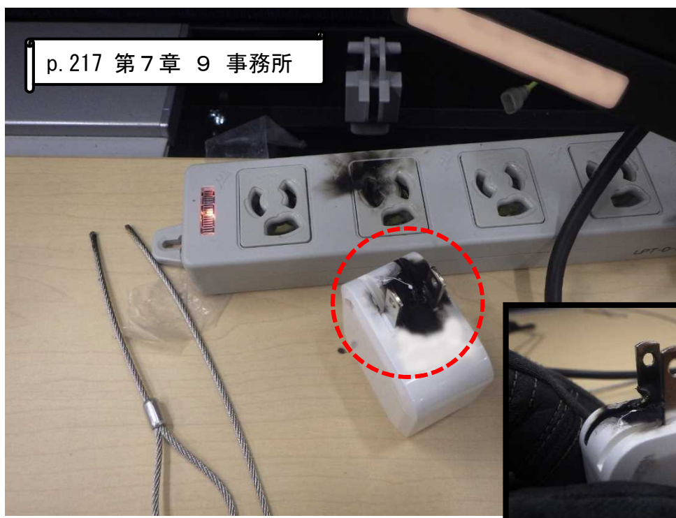
①差込みプラグ間でワイヤーの挟み込み により短絡して出火した火災（2月）
