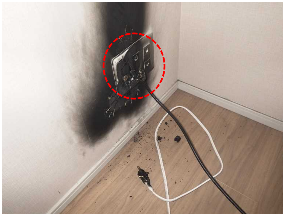
⑨テレビの背面にあるコンセントから トラッキングにより出火した火災（6月）
