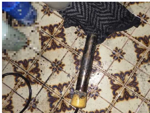
写真 14-6 投込湯沸器の焼損状況
