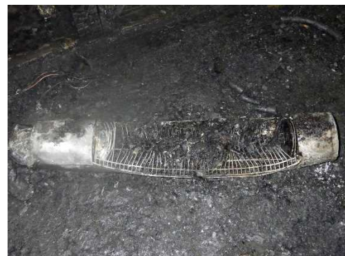
写真 14-2 カーボンヒータの焼損状況
