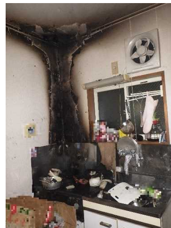
写真 7-3 台所の焼損状況
