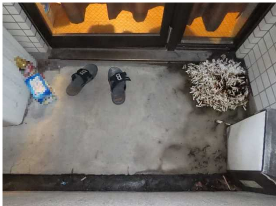
写真 2-3 出火したベランダの状況
