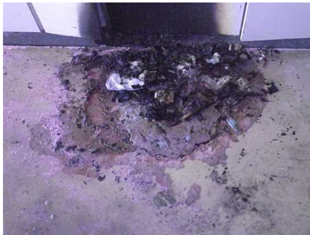
写真 23-4 焼損したごみ箱の状況
