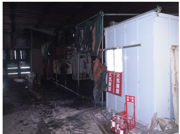
写真 28-4 屋外資器材置き場の焼損状況
