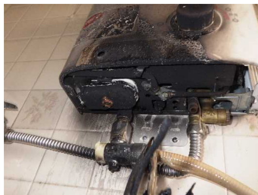
写真 2-2 湯沸かし器の焼損した状況
