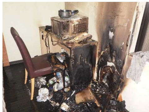
写真 21-2 出火箇所の状況
