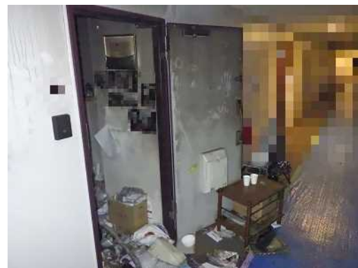
写真 18-3 出火室入口の焼損状況
