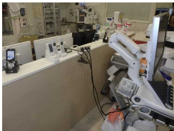
写真 22-3 テーブルタップの接続状況（再現）
