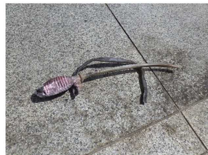
写真 10-3 焼損した注油ポンプ
