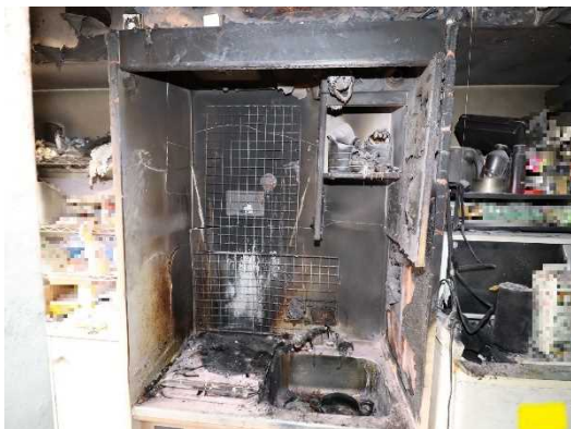
写真 9-3 台所の焼損状況
