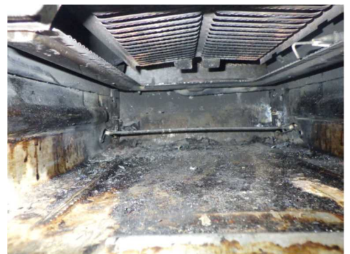
写真 7-8 グリル内の焼損状況
