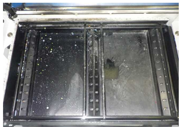
写真 24-2 敷地内の焼損状況
