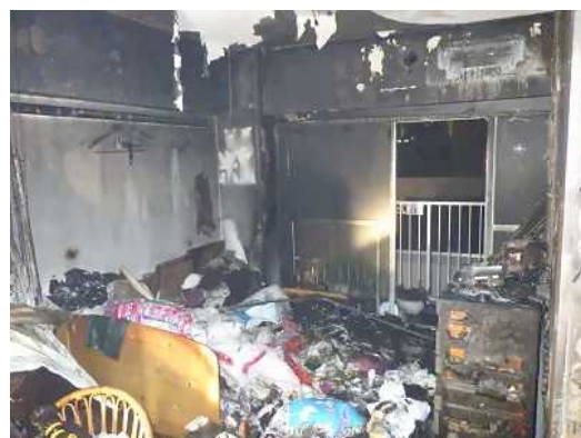
写真 18-5 出火室の焼損状況
