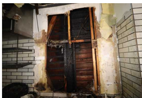
写真 7-2 内壁の焼損状況
