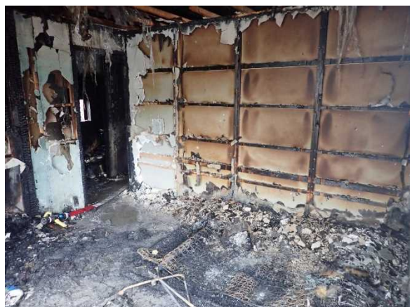
写真 18-6 出火室の焼損状況
