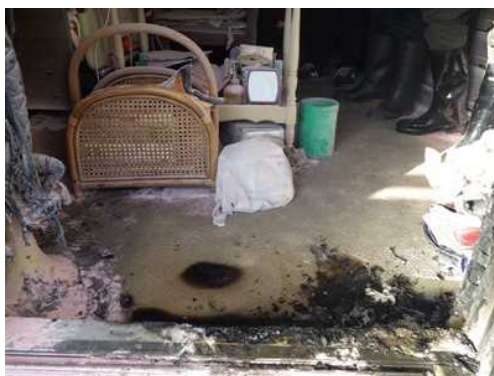
写真 31-1 出火室の状況
