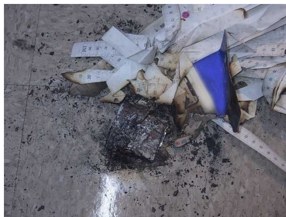
写真 6-8 焼損したバッテリーの状況
