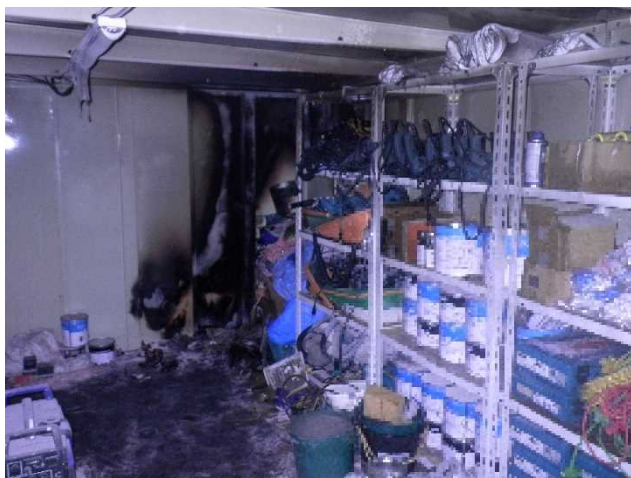
写真 25-1 焼損した倉庫の状況
