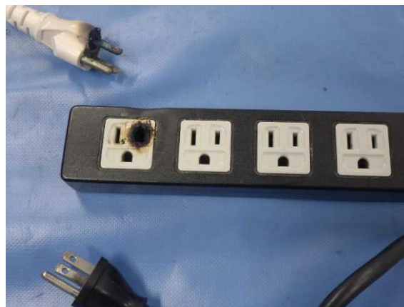
写真 22-4 テーブルタップの焼損状況
