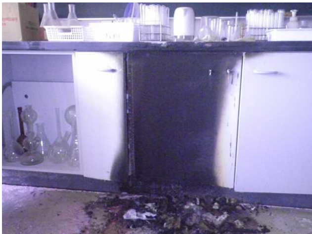
写真 23-3 化学実験室の焼損状況
