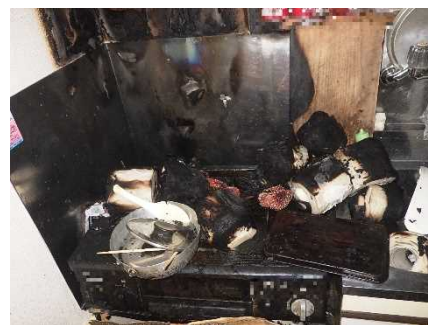
写真 7-4 ガステーブルの焼損状況
