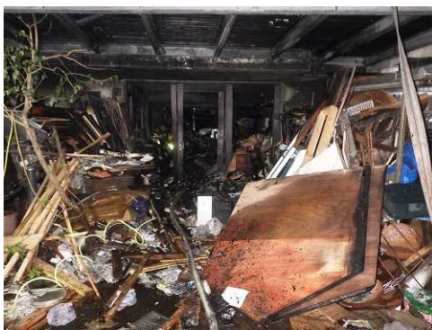
写真 14-3 居室内の焼損状況
