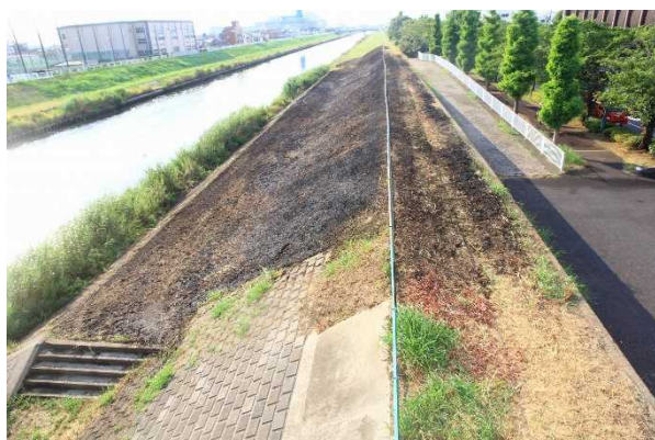
写真 3-1 枯草の焼損状況
