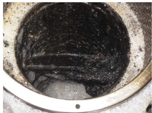
写真 19-4 作動しなかった防火ダンパーの状況
