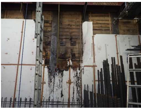
写真 16-4 焼損した断熱材の状況
