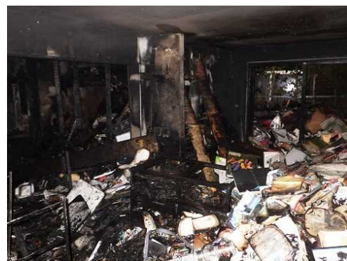
写真 14-4 居室内の焼損状況
