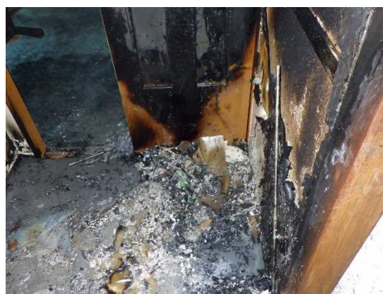
写真 4-2 脱衣所の焼損（収容物除去後）
