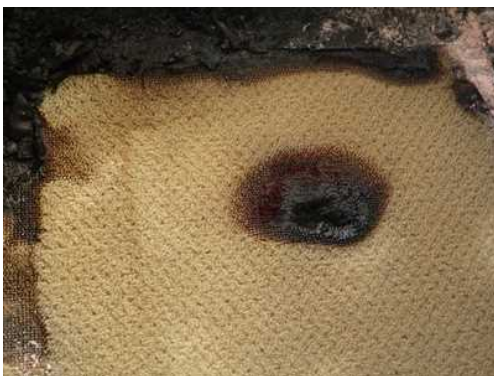
写真 31-2 焼損したカーペットの状況
