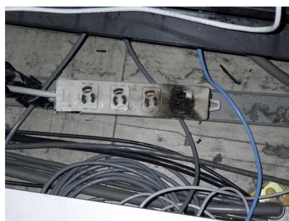
写真 26-4 テーブルタップ付近の焼損状況
