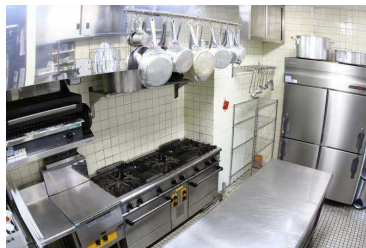
火気使用設備（厨房設備）
