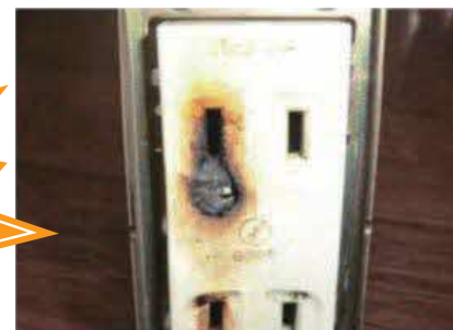
コンセントから出火したもの▲
