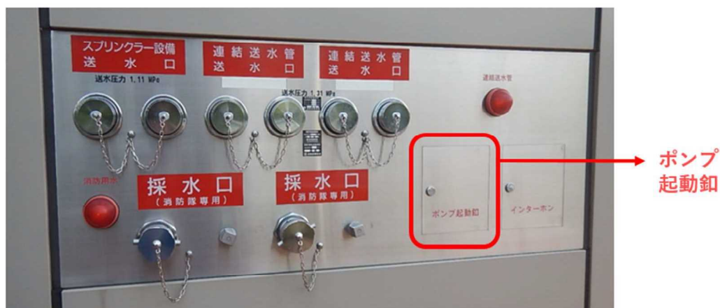
図2-3-16 採水口の直近に設けられたブースターポンプ起動ボタンの例
