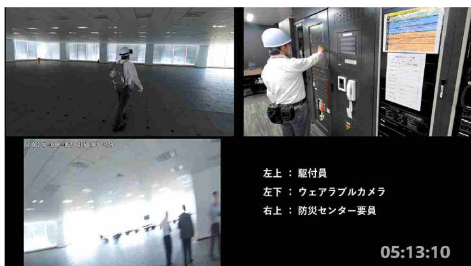
5分13秒 防災センター勤務員が常用エレベーターの火災管制を確認
