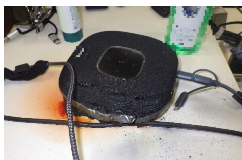
写真４ 焼損したスピーカーの状況
