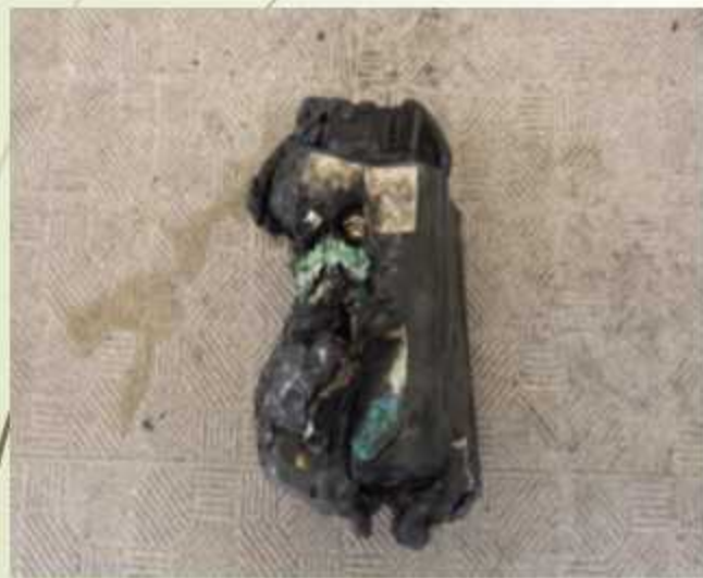
電気設備機器による出火
