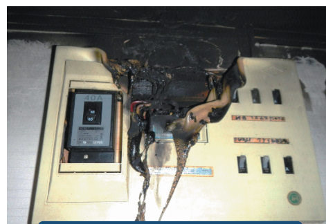
ブレーカーが燃えた火災
