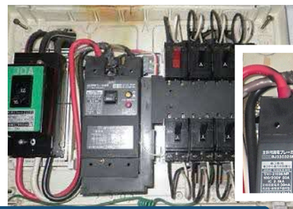
ブレーカーの小さなこげ跡
