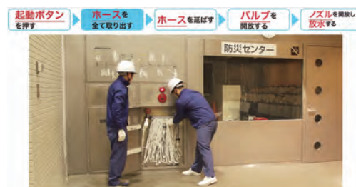
▲「ネットで自衛消防訓練（消防用設備等の取扱い編）」屋内消火栓設備の使用方法（動画）
