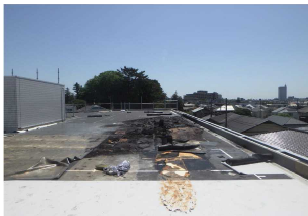
写真 28-3 り災建物 屋上の焼損状況
