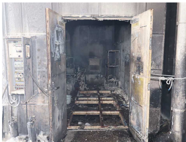
写真 7-6 一般取扱所の焼損状況
