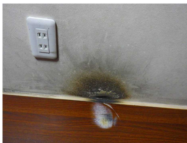
写真 6-9 内壁の焼損状況
