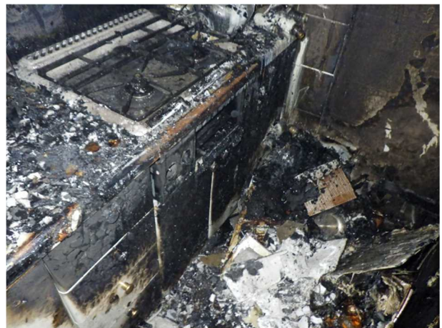
写真 7-4 ガステーブルの焼損状況
