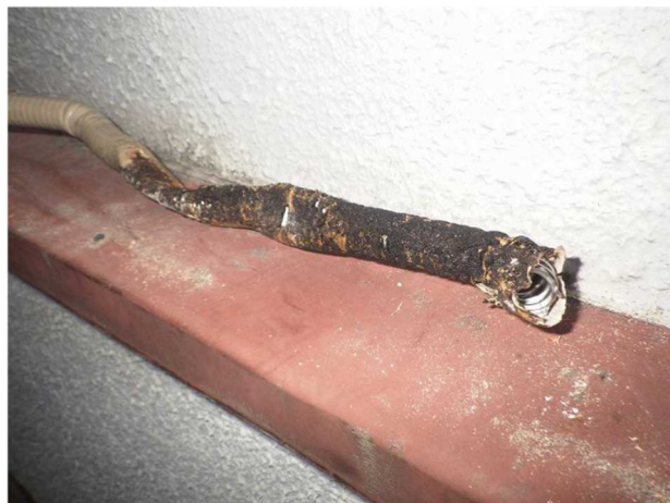
写真 16-2 焼損したガスホースの状況
