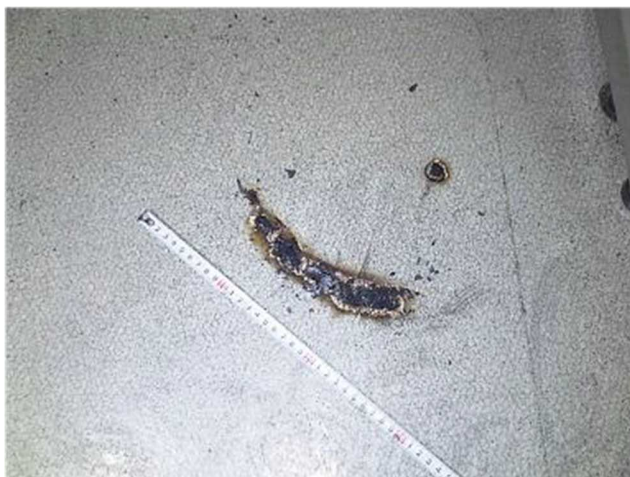
写真 22-3 床の焼損状況
