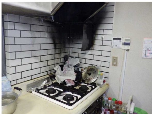
写真 18-3 台所の焼損状況
