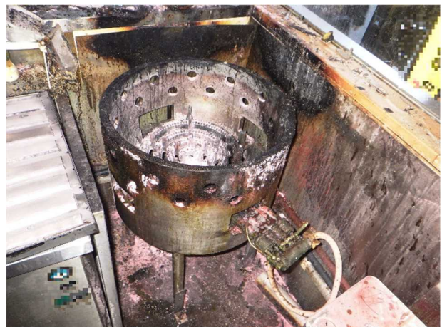
写真 27-2 大型ガスこんろの焼損状況
