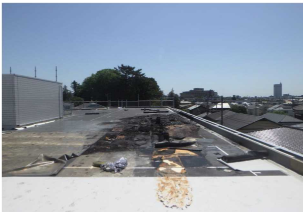
写真 28-3 り災建物 屋上の焼損状況
