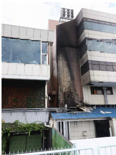
写真 7-5 建物の焼損状況
