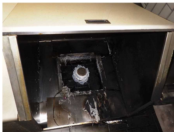
写真 18-4 レンジフードの焼損状況
