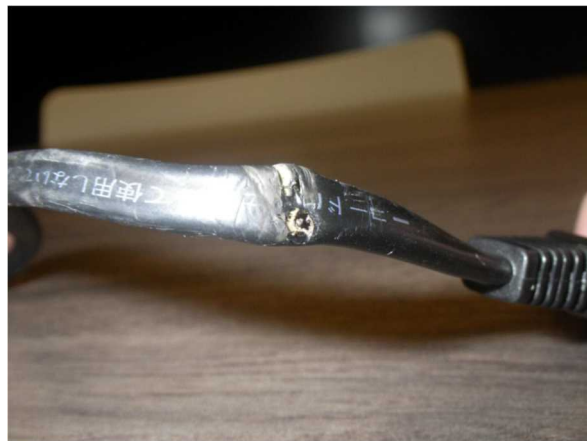
写真 26-5 焼損したコードの状況
