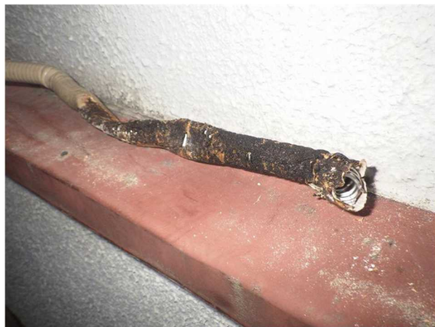
写真 16-2 焼損したガスホースの状況
