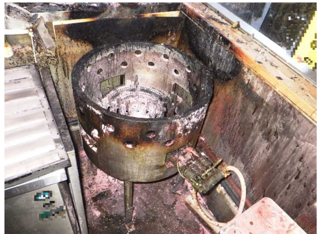
写真 27-2 大型ガスこんろの焼損状況
