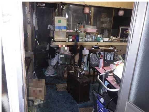
写真 8-3 焼損した石油ストーブ周囲の状況
