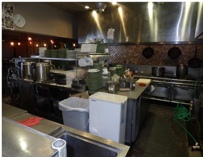
写真 9-3 調理場の焼損状況
