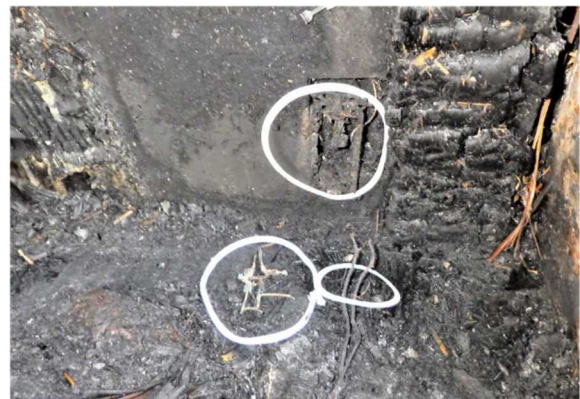
写真 14-2 壁付コンセントの焼損状況
