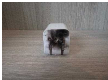
写真10 直流電源装置の焼損状況
