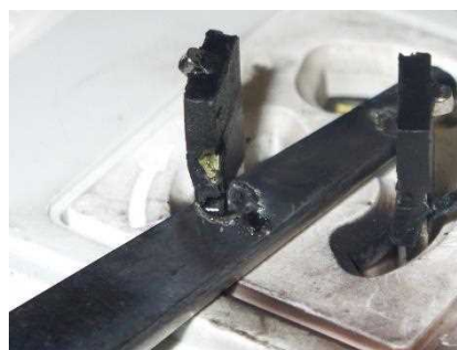
写真4 はさみとプラグの接触箇所
