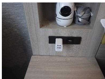
写真9 火災発生場所付近の状況
