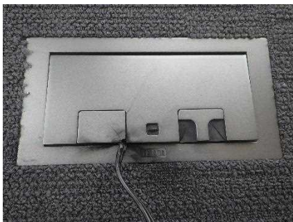
写真1 出火時の状況（孔の使用なし）
