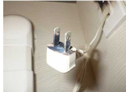
写真２ 焼損した差込みプラグ
