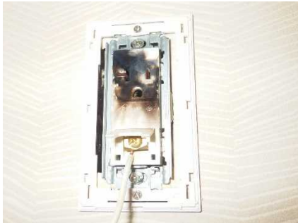
写真１ 焼損したコンセント
