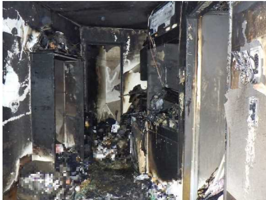
写真5 居室内の焼損状況
