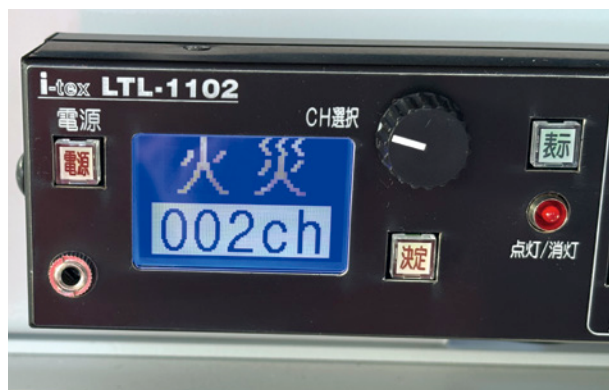
電光掲示板コントローラー
