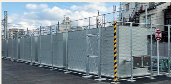
▲ 地上設置型防火水槽 5基連結 (20立方メートル×5基)
