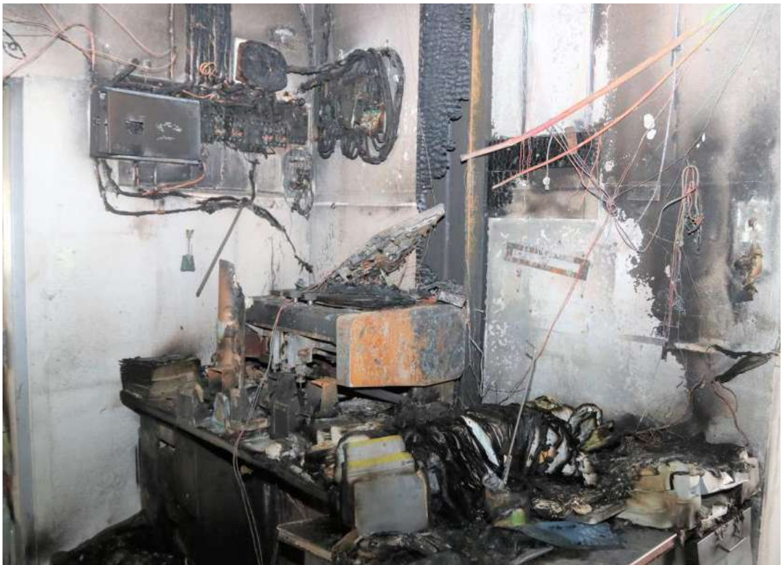
作業所から出火した火災（7月）
