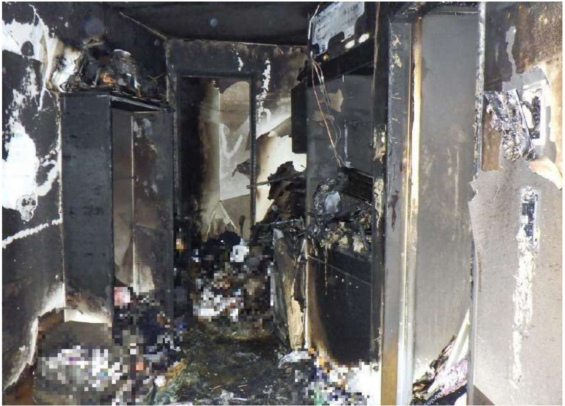
①充電中のモバイルバッテリーから出火した火災（3月）
