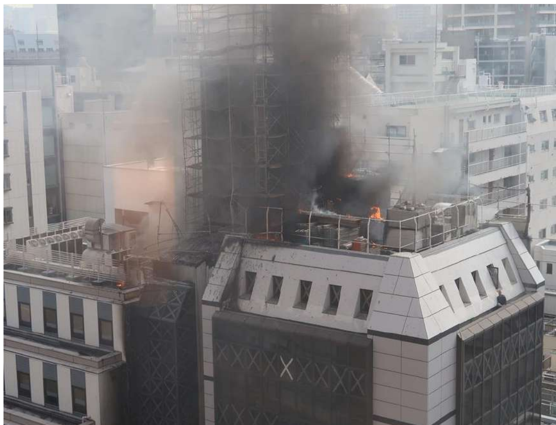
①解体中の建物の延焼状況（3月）
