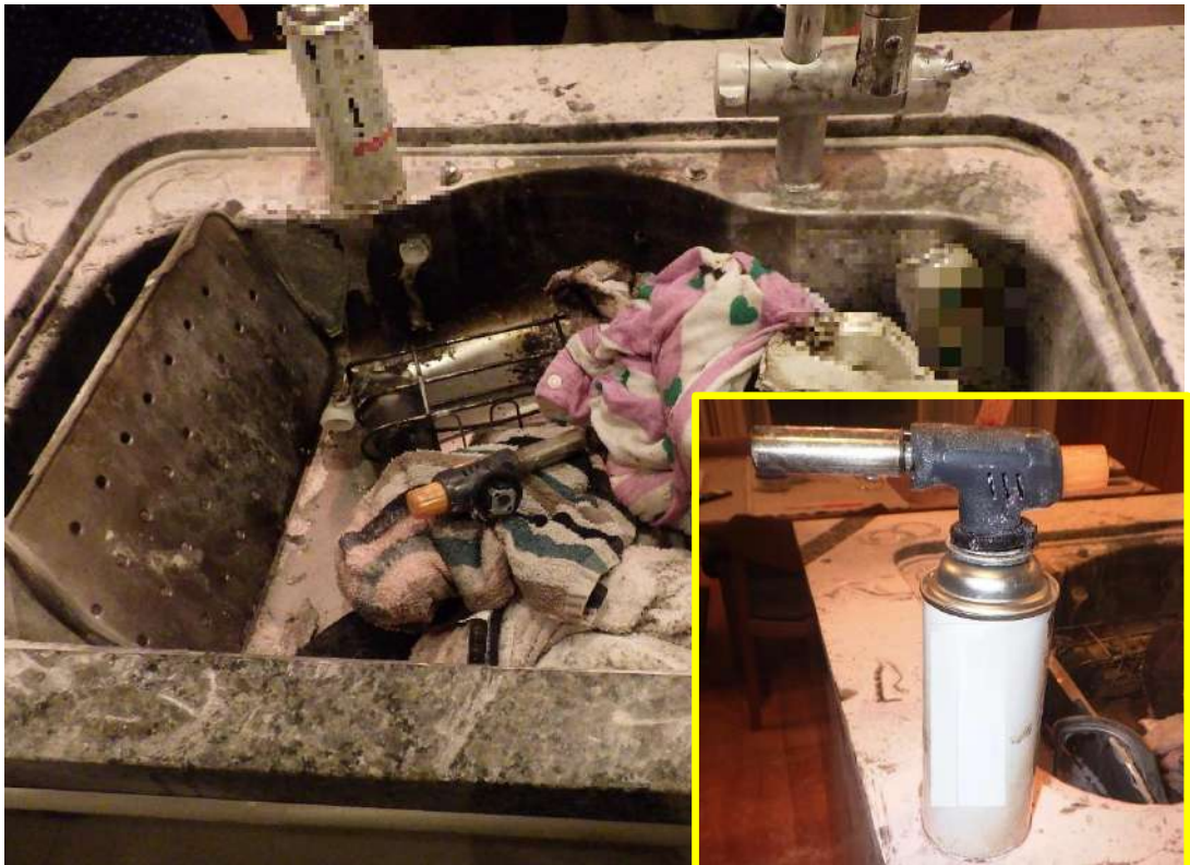
②ボタンガストーチバーナのガス導管から漏気したガスに引火して出火した火災（5月）
