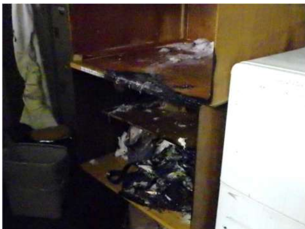
写真 27-3 更衣室内の棚の焼損状況
