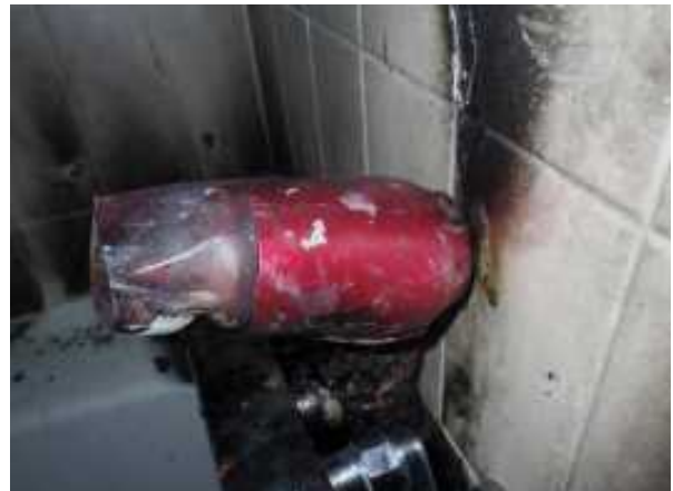
写真 27-2 ドライヤーの焼損状況
