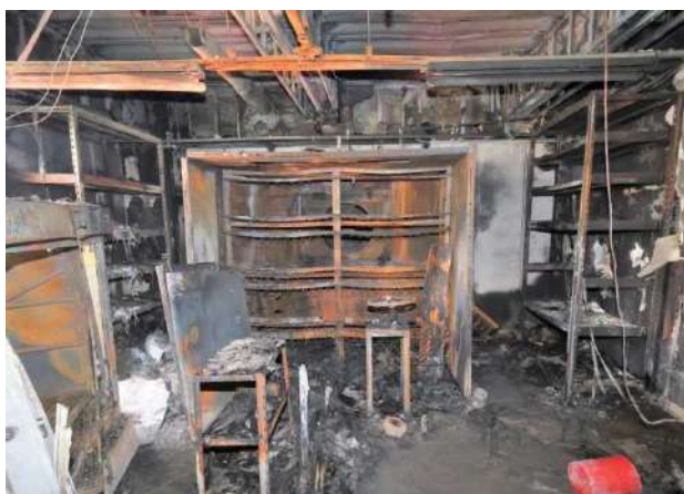
写真 28-3 出火室の焼損状況
