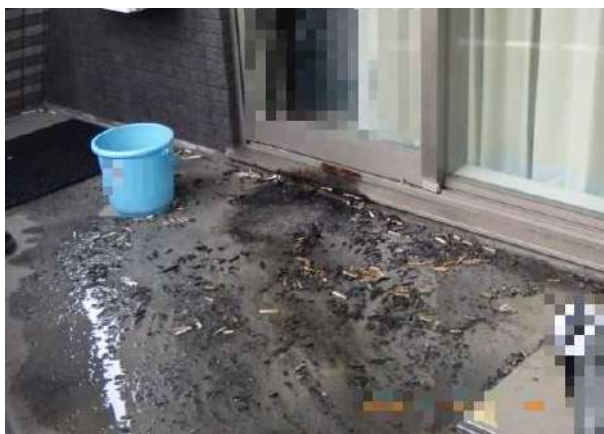
写真 2-3 ベランダの焼損状況
