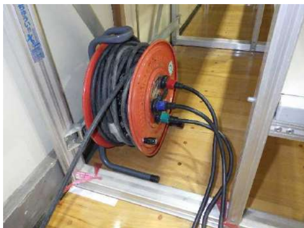
写真 23-1 コードリールの状況
