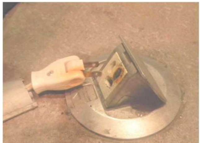
写真 20-4 焼損物件の状況
