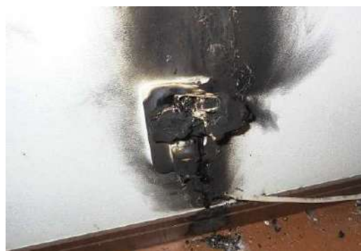
写真 18-1 現場の焼損状況
