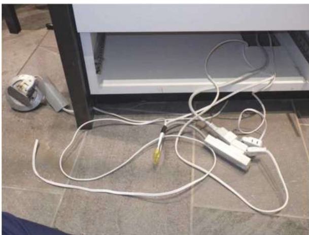
写真 20-3 接続していた配線の状況
