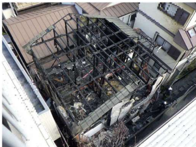
写真 18-8 建物の焼損状況
