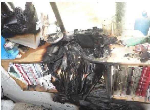
写真 5-1 棚の焼損状況
