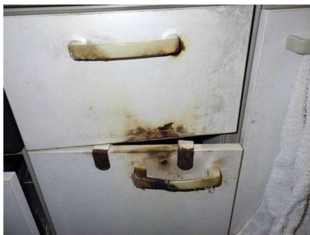
写真 7-4 焼損箇所の状況
