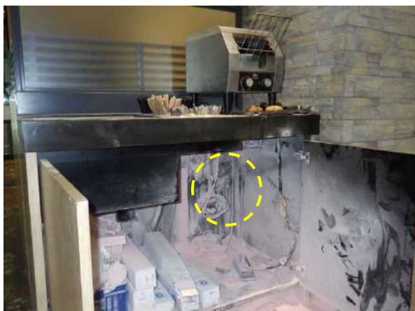
写真 32-1 キャビネット周囲の状況
