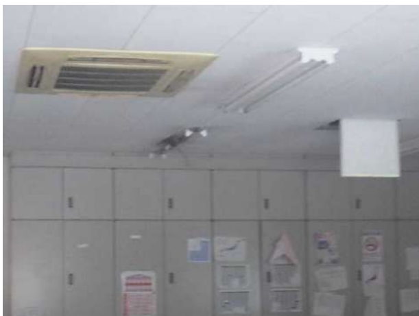
写真 25-1 天井の焼損状況
