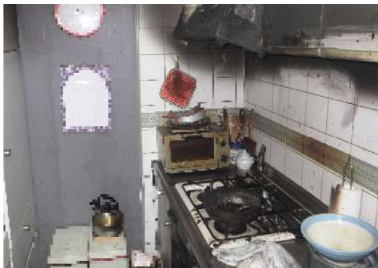
写真 9-1 台所の焼損状況
