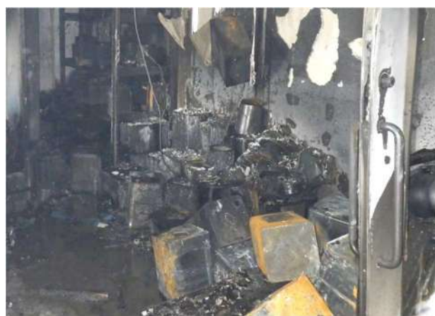
写真 28-4 出火室に置かれていた危険物
