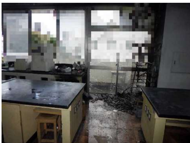
写真 10-3 化学実験室の焼損状況
