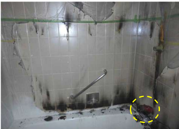
写真 27-1 浴室内の焼損状況
