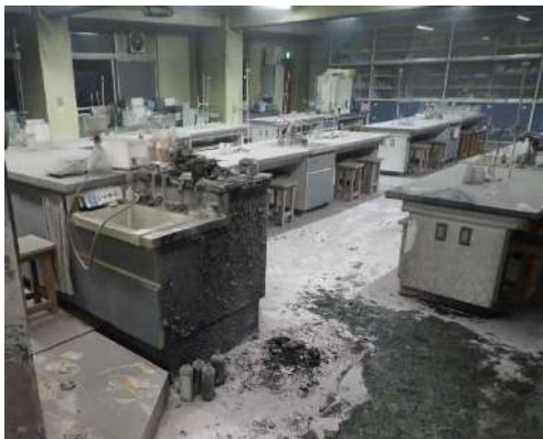
写真23-3 化学室の焼損状況
