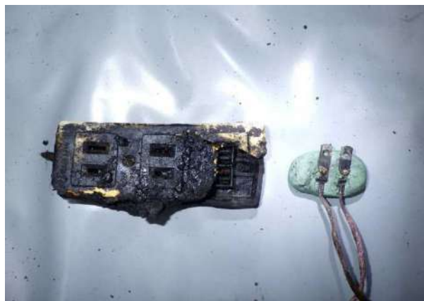
写真 14-4 テーブルタップの焼損状況
