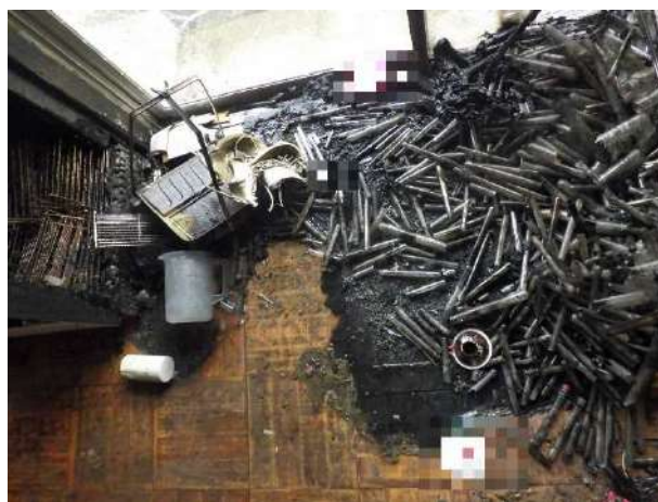
写真 10-4 出火箇所の状況
