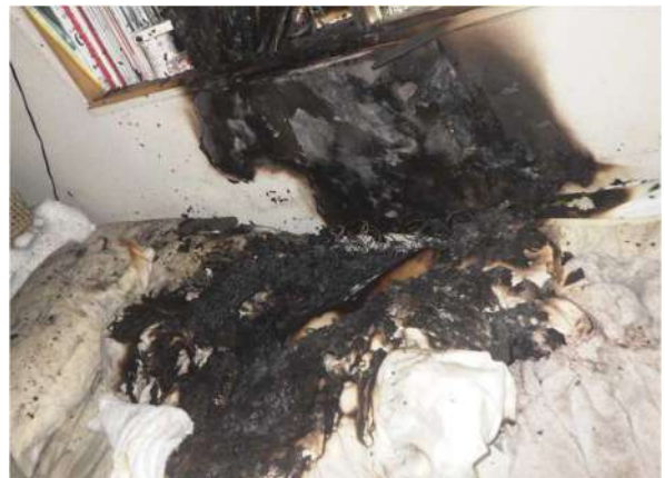
写真 5-2 布団の焼損状況
