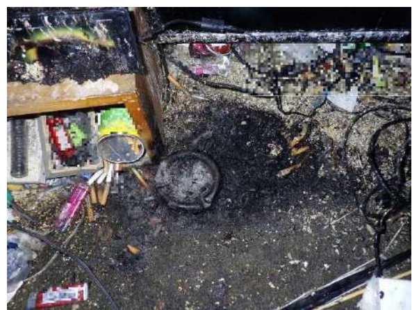
写真 18-5 灰皿周辺の焼損状況
