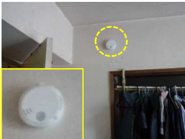
写真 18-4 住宅用火災警報器の設置状況
