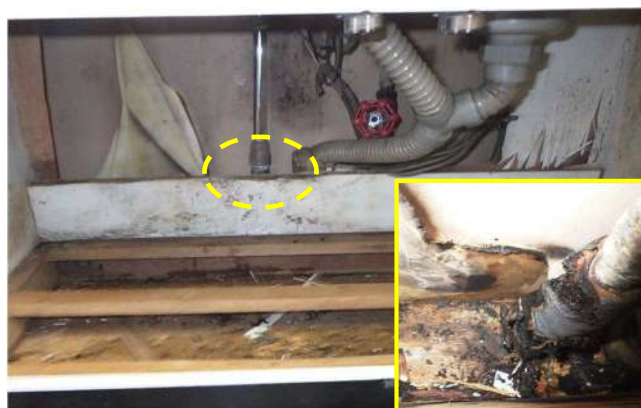
写真 22-2 流し台の焼損状況
