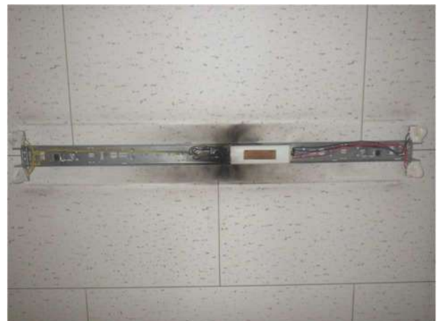
写真 25-2 蛍光灯安定器の焼損状況
