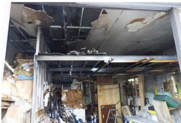
写真 25-3 焼損した倉庫の状況
