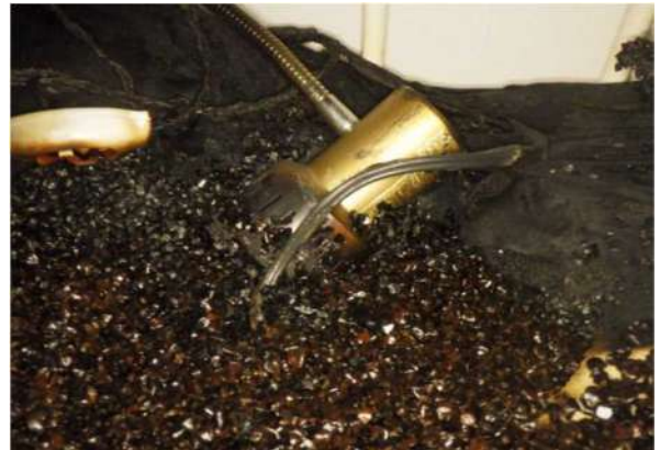
写真 30-2 クリップライトの焼損状況
