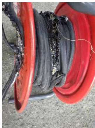
写真 23-2 コードリールの焼損状況
