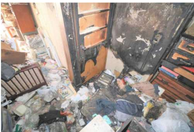
写真 6-1 焼損した電気ストーブ周辺の状況
