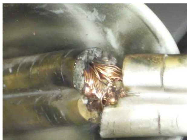
写真 22-4 コードの焼損箇所
