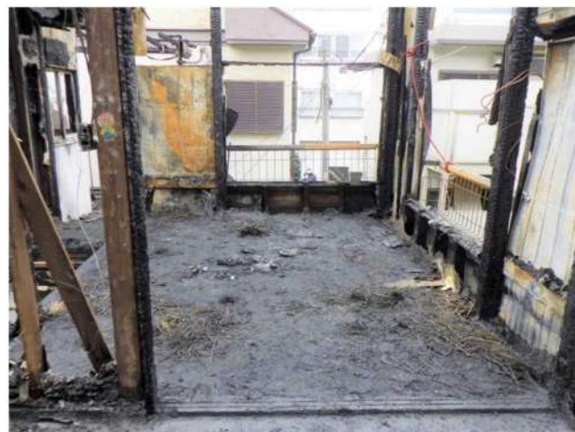
写真 18-9 出火室の焼損状況
