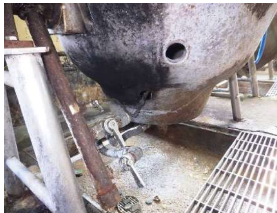
写真 12-2 コック付近の状況
