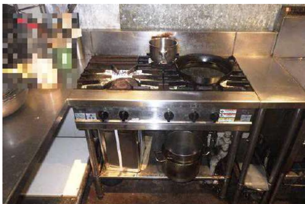
写真 17-3 業務用ガスこんろの状況
