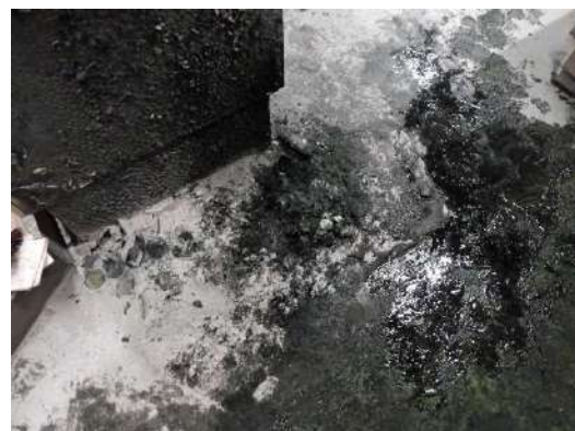
写真23-4 出火箇所の状況
