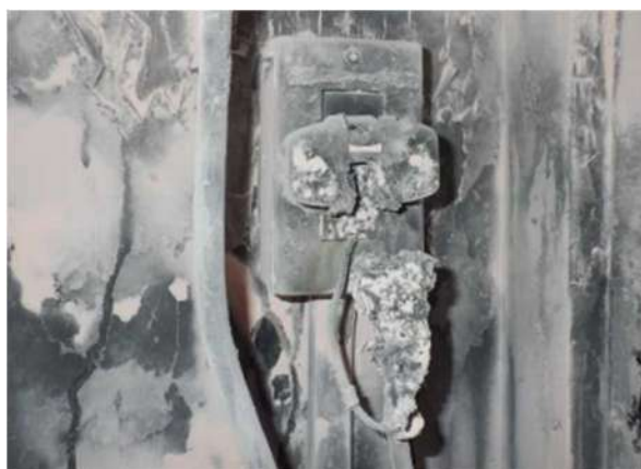
写真 32-2 マルチタップの焼損状況
