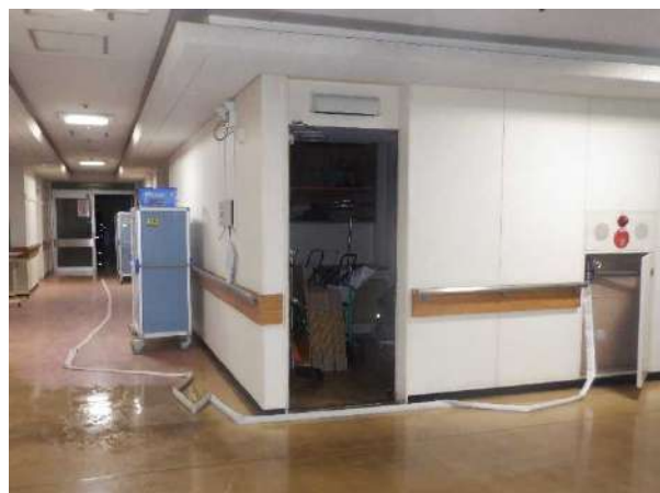
写真 27-4 屋内消火栓設備の使用状況
