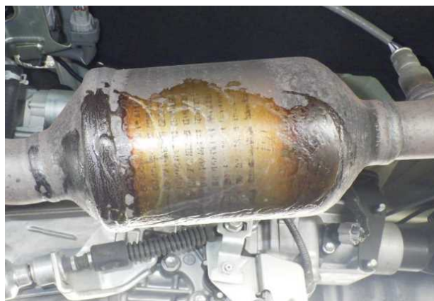
写真 29-4 排気管の焼損状況
