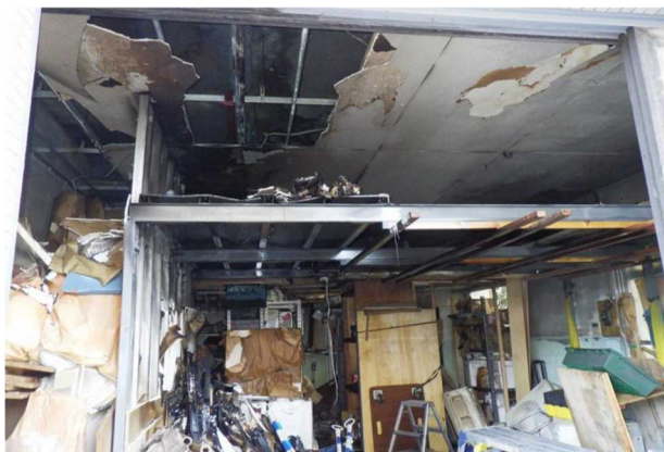
写真 25-3 焼損した倉庫の状況
