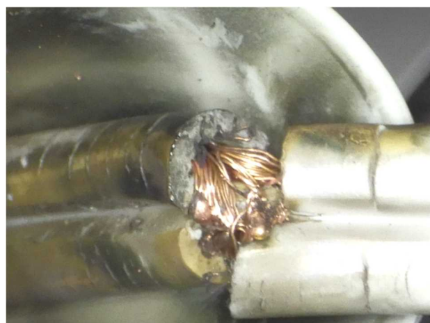
写真 22-4 コードの焼損箇所
