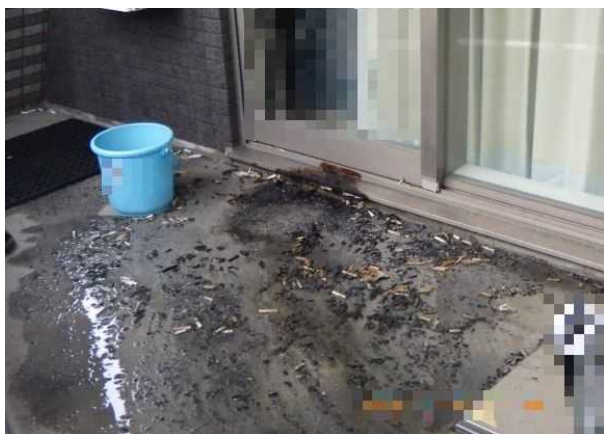
写真 2-3 ベランダの焼損状況
