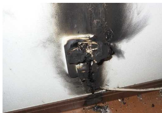
写真 18-1 現場の焼損状況
