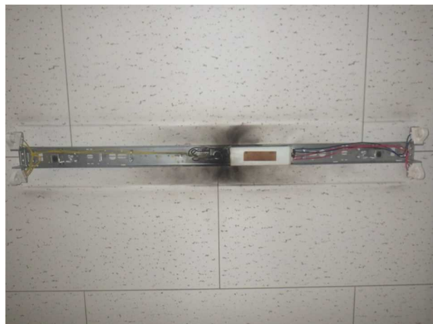
写真 25-2 蛍光灯安定器の焼損状況
