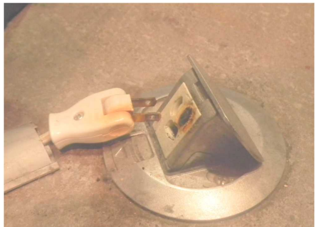
写真 20-4 焼損物件の状況
