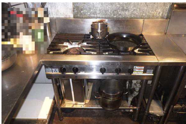
写真 17-3 業務用ガスこんろの状況
