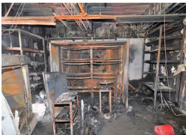
写真 28-3 出火室の焼損状況
