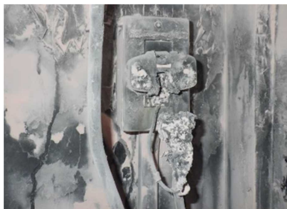
写真 32-2 マルチタップの焼損状況
