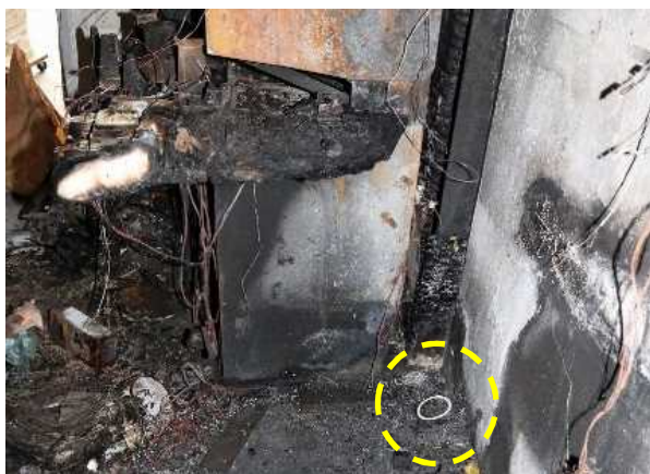
写真24-1 作業場内の焼損状況
