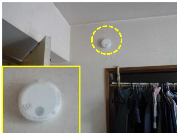
写真 18-4 住宅用火災警報器の設置状況
