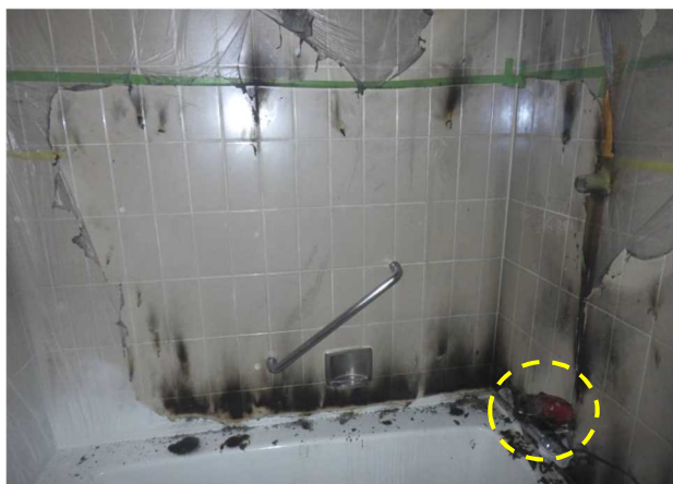
写真 27-1 浴室内の焼損状況
