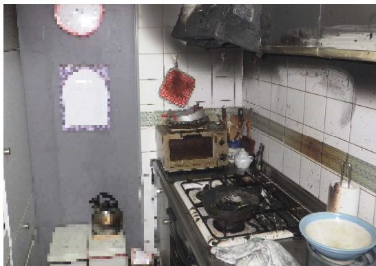
写真 9-1 台所の焼損状況
