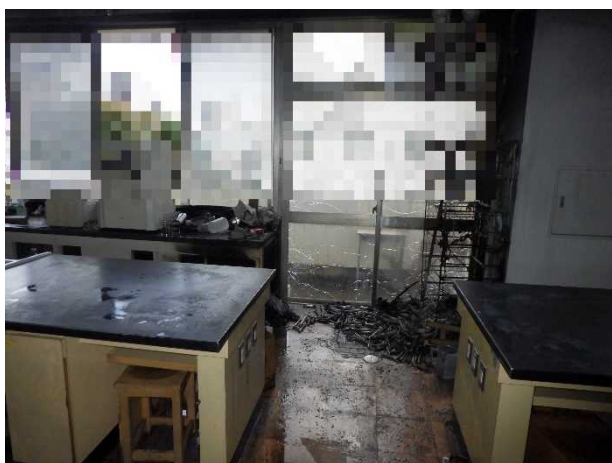
写真 10-3 化学実験室の焼損状況
