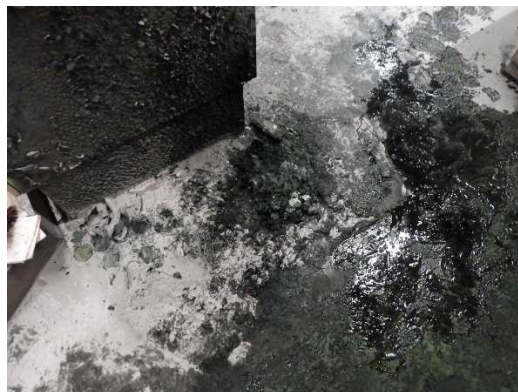
写真23-4 出火箇所の状況
