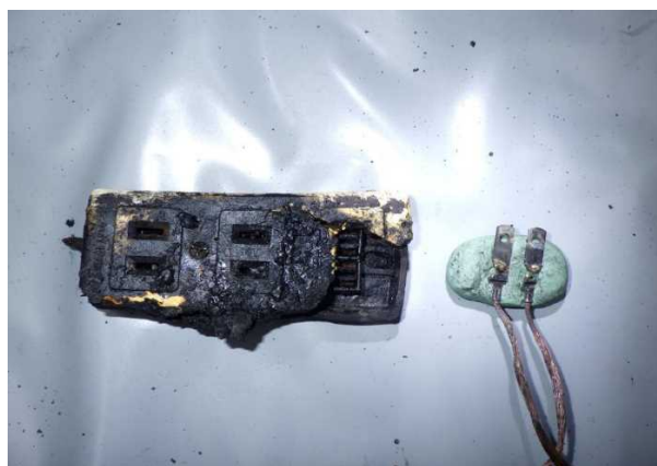
写真 14-4 テーブルタップの焼損状況
