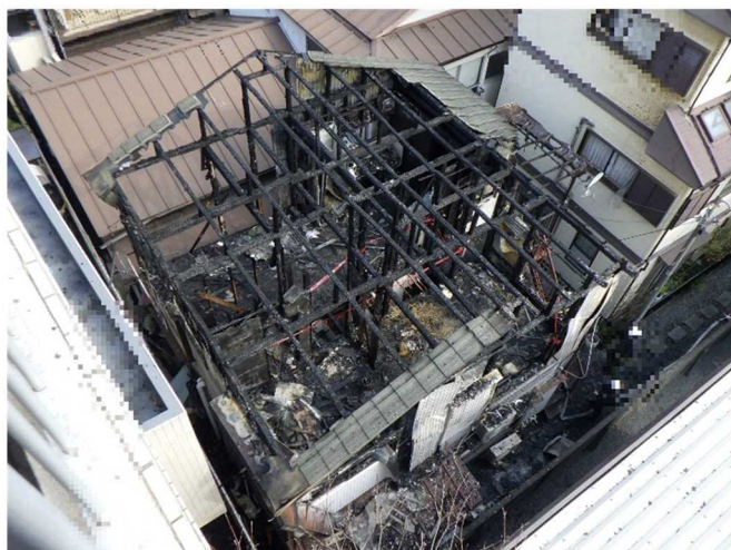
写真 18-8 建物の焼損状況
