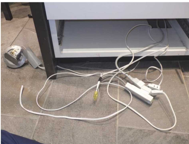
写真 20-3 接続していた配線の状況
