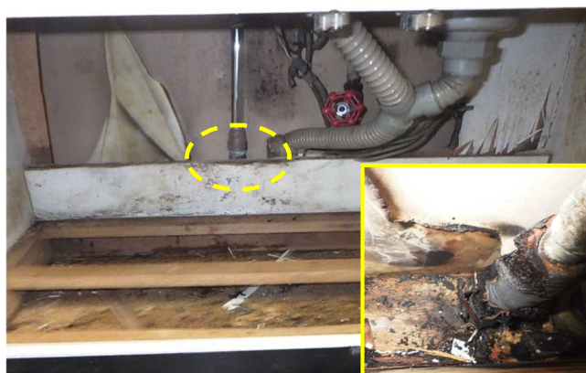
写真 22-2 流し台の焼損状況
