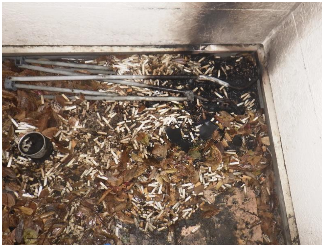
⑧ベランダでたばこの吸い殻を不適当な処に捨てたため出火した火災（2月）
