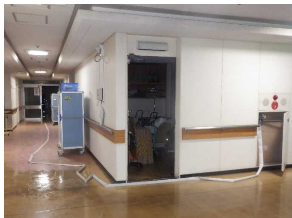
写真 27-4 屋内消火栓設備の使用状況
