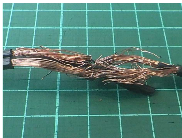
写真 26-2 コードの焼損状況
