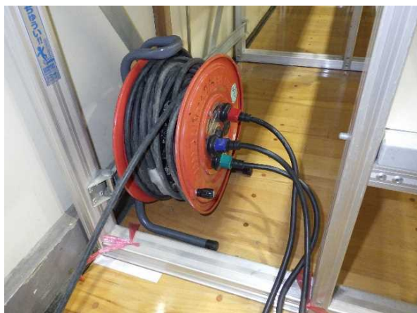
写真 23-1 コードリールの状況
