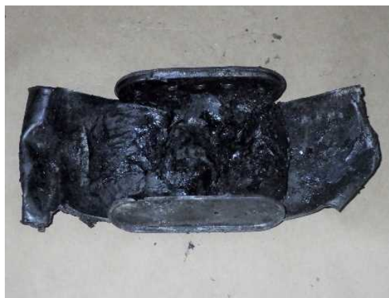
写真24-2 低圧進相コンデンサの焼損状況
