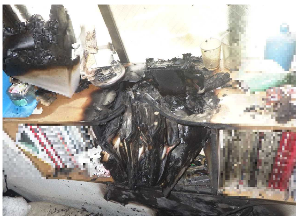
写真 5-1 棚の焼損状況
