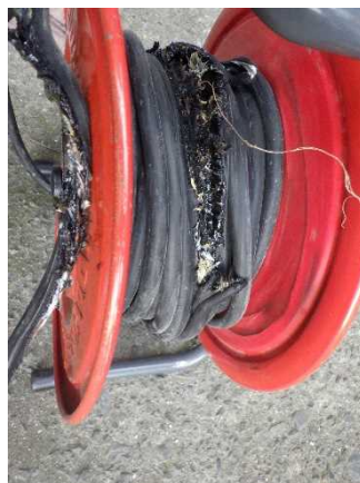
写真 23-2 コードリールの焼損状況
