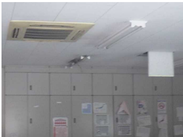
写真 25-1 天井の焼損状況
