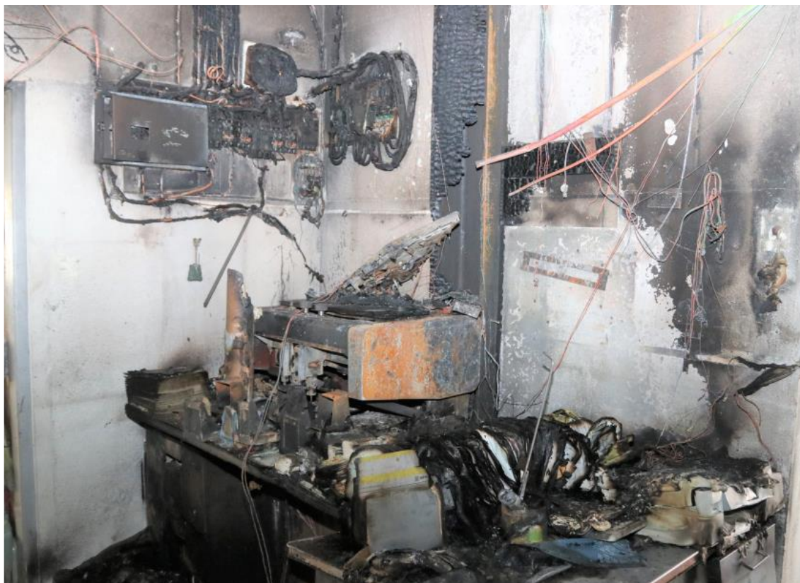
作業所から出火した火災（7月）
