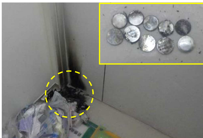
写真 30-3 廃棄物保管庫の焼損状況
